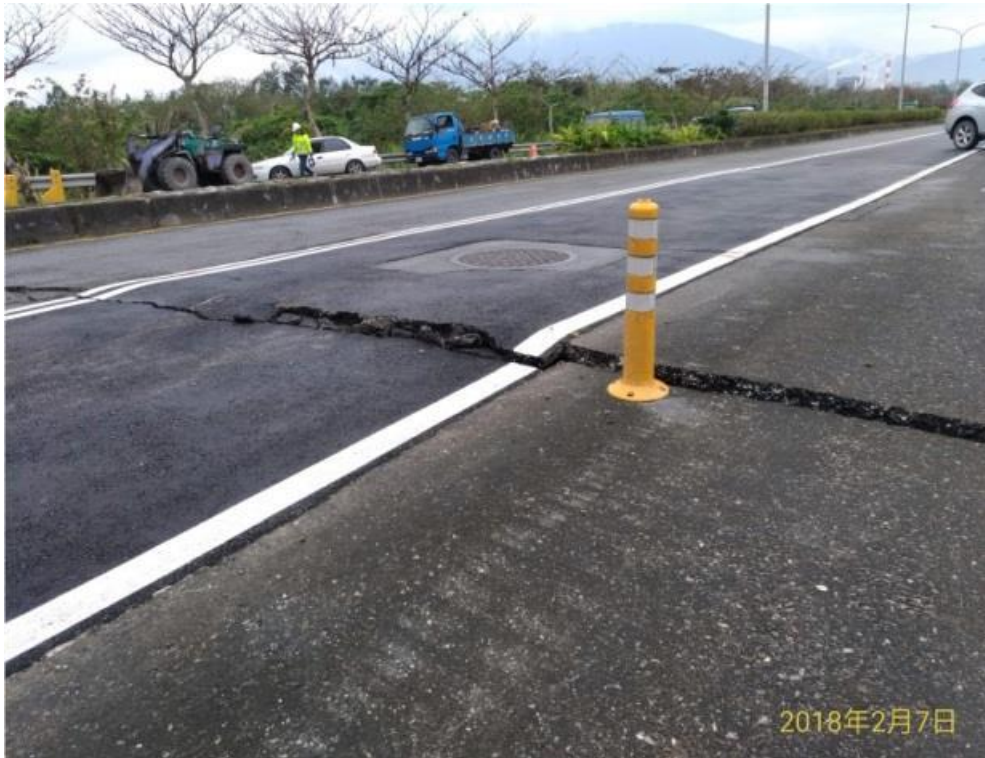
圖 5 A1 進橋板擠壓隆起(南下側)
