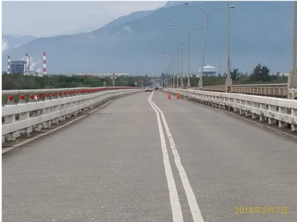
圖 6 S10 跨斷層水平錯動，位移致中心線偏移，相對位移約 52cm
