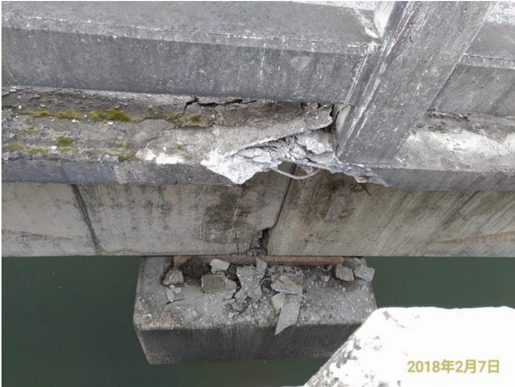
圖 8 二代橋 P10 止震塊碎裂
