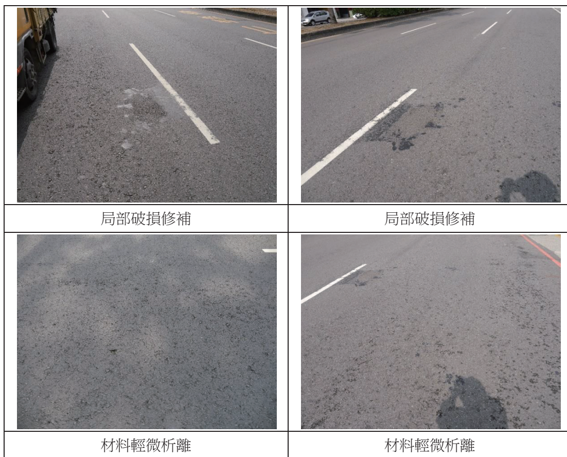
圖 14 現場目視主要破壞狀況
