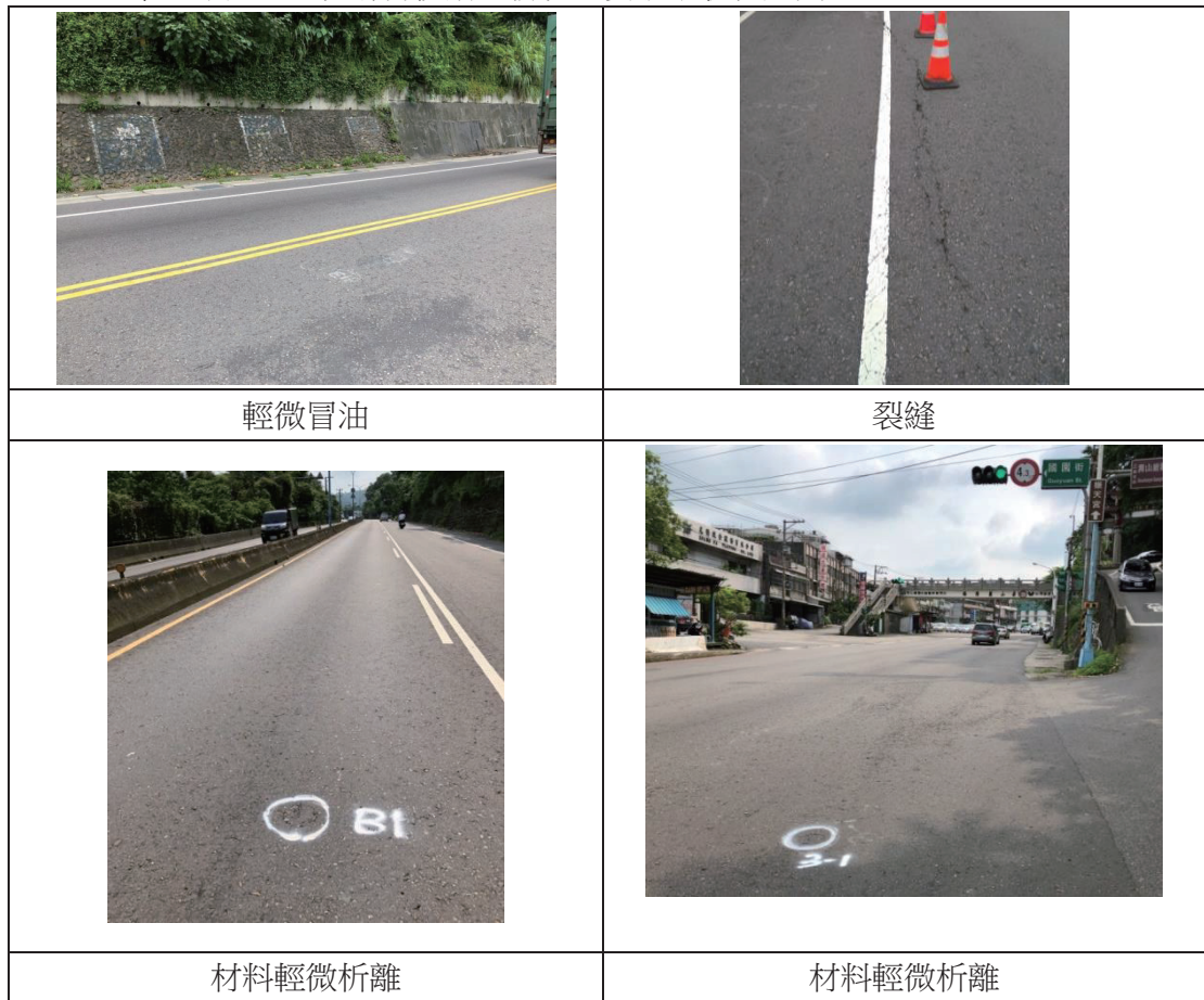
圖 8 現場目視主要破壞狀況
