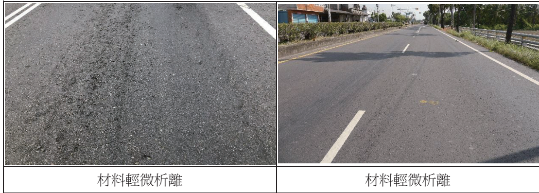
圖 19 現場目視主要破壞狀況
