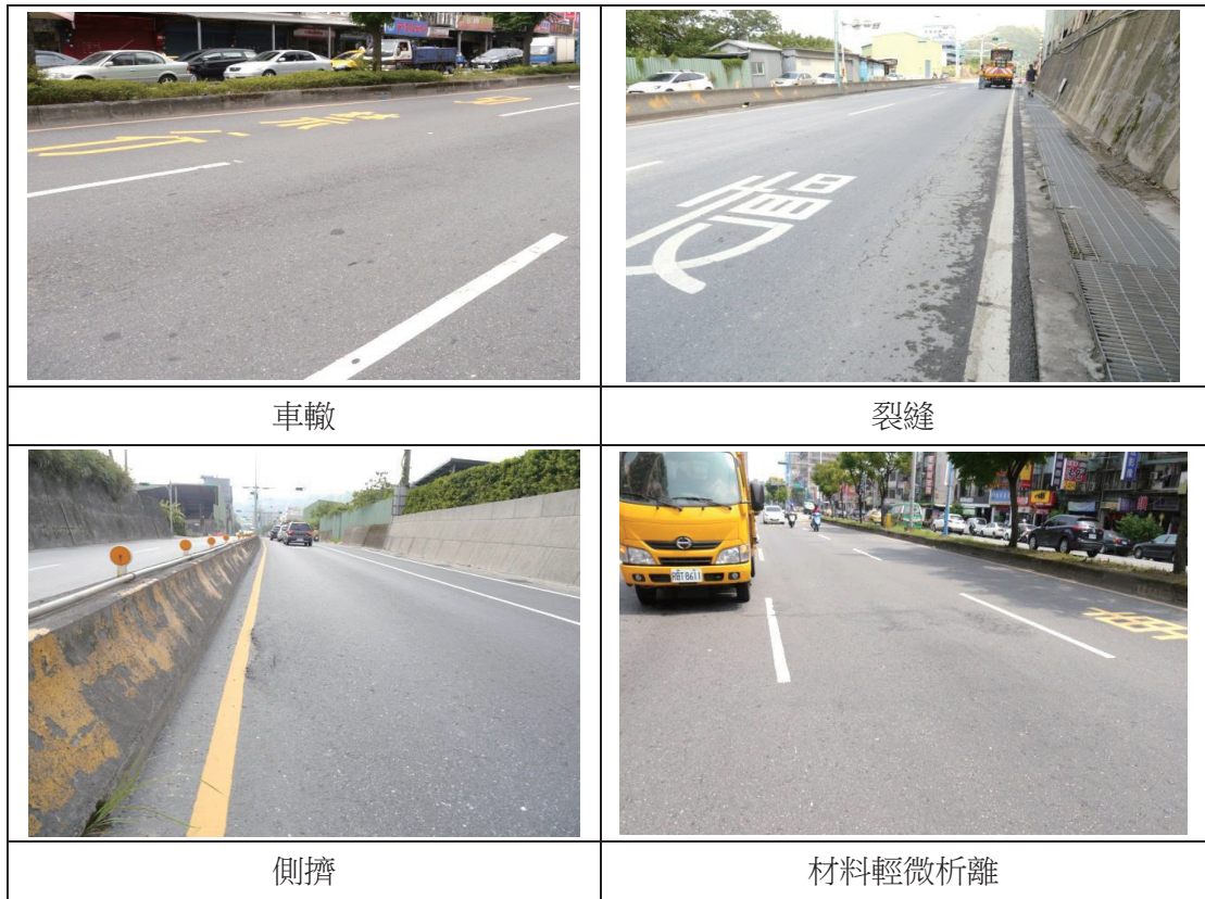
圖 9 現場目視主要破壞狀況
