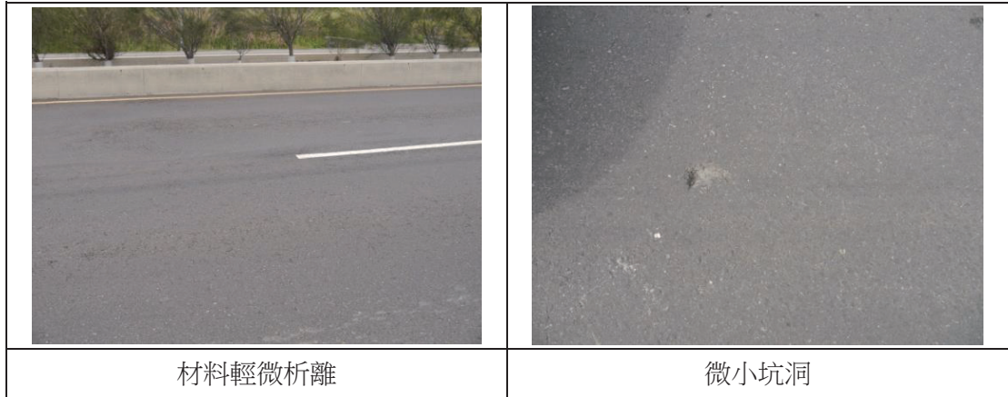
圖 28 現場目視主要破壞狀況
