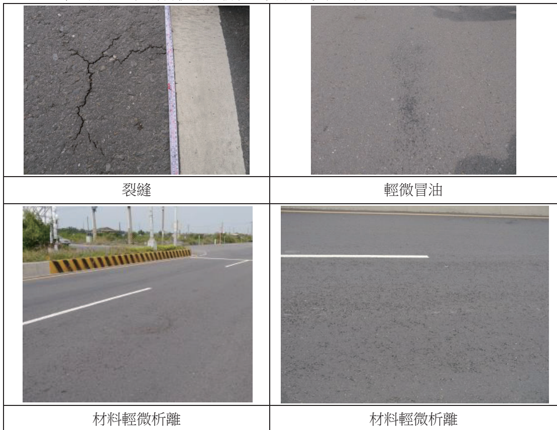
圖 29 現場目視主要破壞狀況
