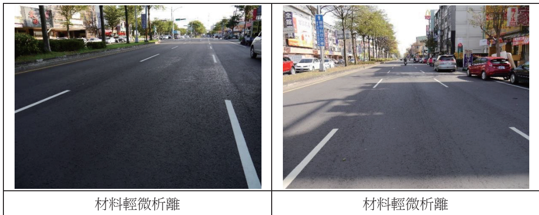
圖 13 現場目視主要破壞狀況
