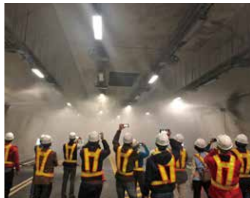
● 仁水隧道水霧系統測試情形
