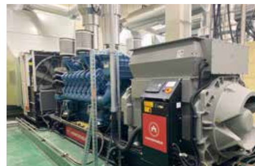
● 特高壓機房發電機測試
