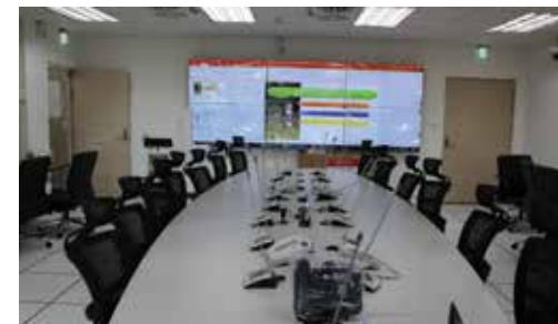
● 南澳交控中心控制室控制桌實景
