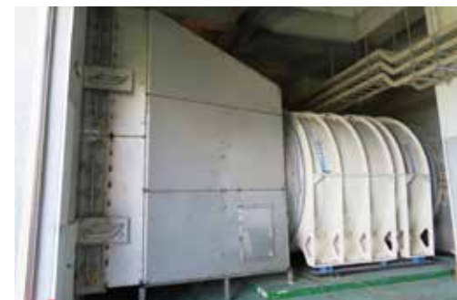
● 中仁隧道軸流式排煙風機
