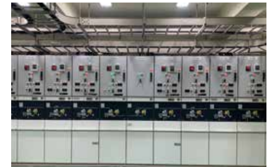
● 特高壓機房保護電驛
