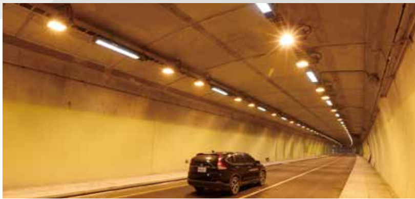
● 觀音隧道照明
