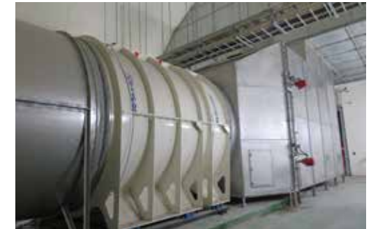
● 仁水隧道排煙軸流式風機
