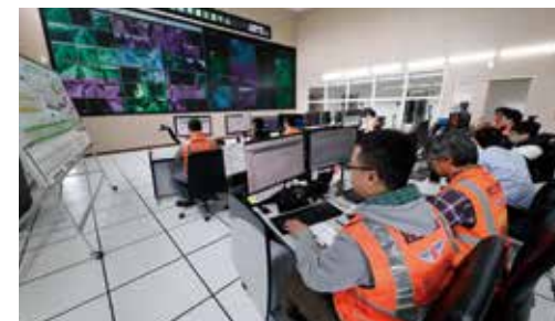
● 南澳交控中心控制室實景
