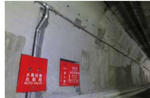
● 仁水隧道消防栓箱及水霧自動閥箱
