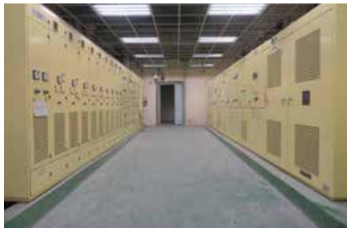
● 輔助機房高低壓配電盤
