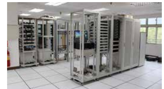
● 南澳交控中心機房設備配置
