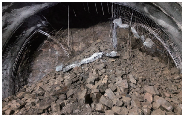
隧道抽坍及處置完成
