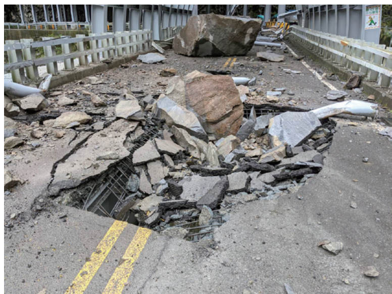
鋼構橋梁受損實景
