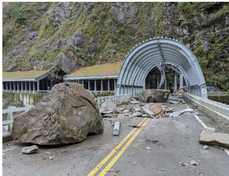
鋼構橋梁受損實景
