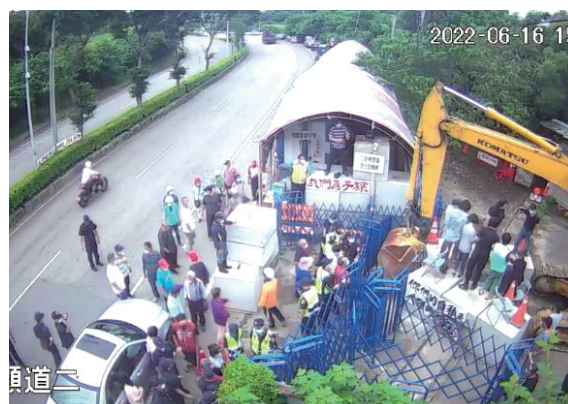
事業廢棄物掩埋場怪手移除自救會設置石塊，爆發衝突（竹南分局提供）
