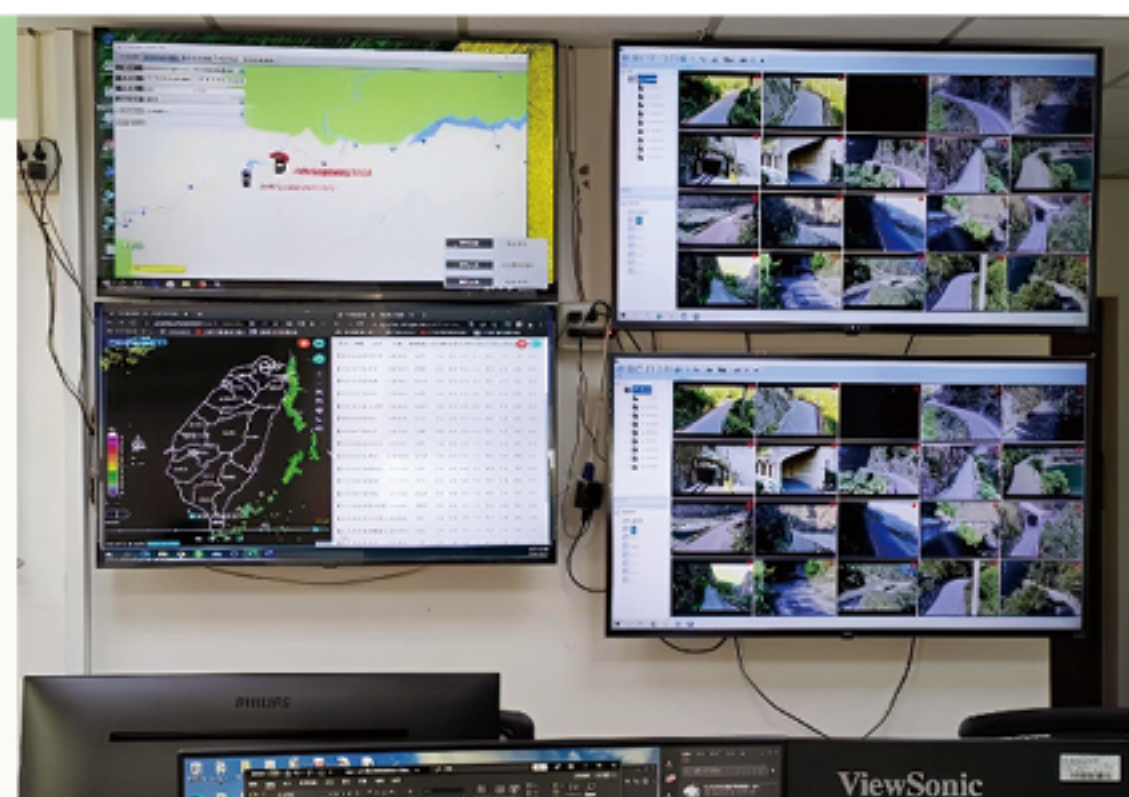
行車管理室監看車行、雨情及路況
