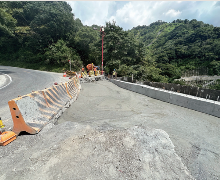
掏空路基修復
