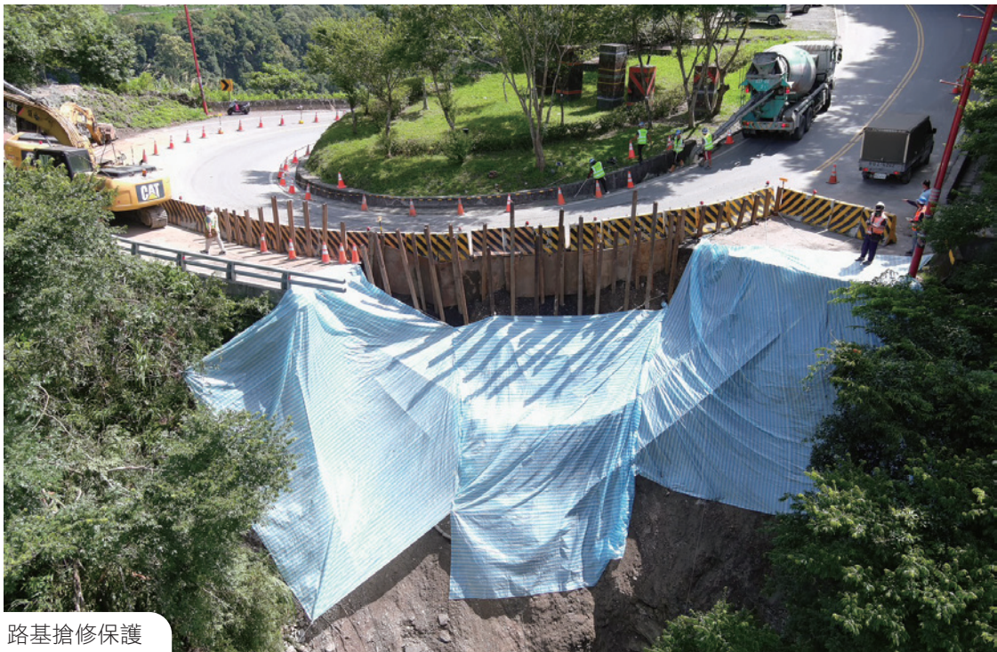
現場掏空情形
