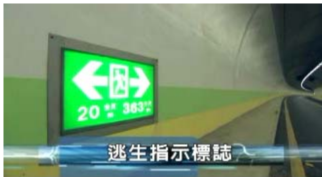
(圖 10) 逃生指示標誌 (資料來源：八卦山隧道宣導短片)
