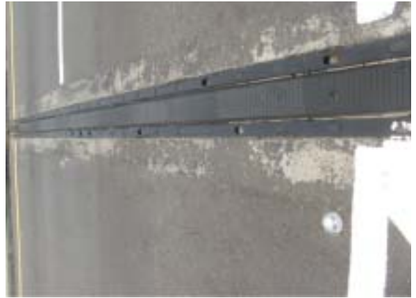
圖4.6 板式橡膠伸縮縫螺栓蓋脫落
