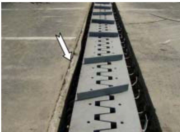
圖4.41 預留槽寬度不足而將錨碇桿件扳彎
