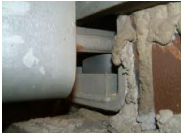
圖4.62 支承鋼箱底部未封模混凝土無法填滿
