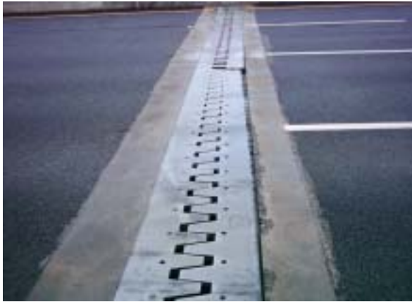
圖4.13 齒型伸縮縫鋼鈑及錨碇構件斷裂脫落 鋼鈑在焊接處斷裂圖
