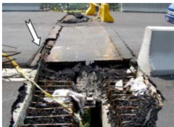
圖4.37 填充材料軟弱或流失覆蓋之鐵板槽會壓陷AC面層
