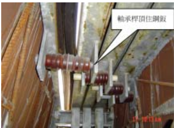
圖4.23 等距彈簧軸承桿頂住鋼板造成縫距不均
