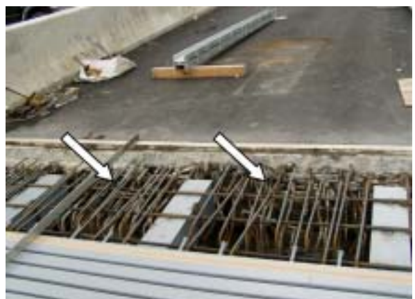
圖4.44 鋼筋預留雜亂橋面版端模處理不善內部多孔洞
