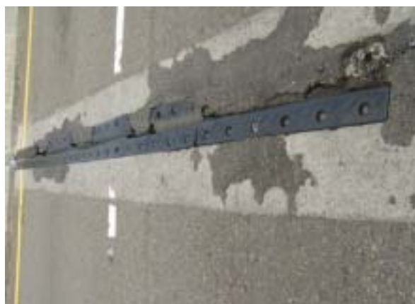
圖3.2 SHO-BOND橡膠破裂脫落(損壞嚴重者)
