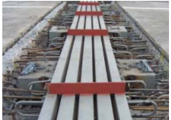
圖4.54 伸縮縫以角鋼焊接固定現場調整縫距困難
