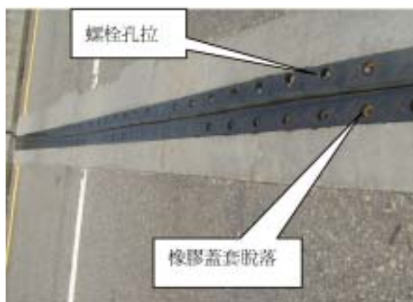
圖3.1 SHO-BOND橡膠蓋套脫落螺栓孔拉裂 (損壞較輕微者)
