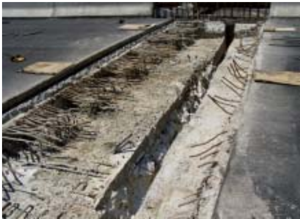
圖4.39 預留鋼筋不正確須作植筋處理
