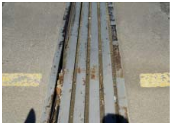
圖4.24 模組型縫中填滿砂土影響正常伸縮
