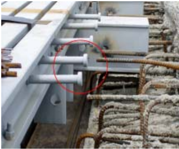
圖4.51 拖座間距太大鋼箱支承點未坐落在混凝土拖座上
