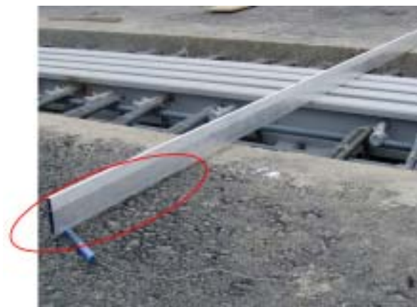
圖4.49 伸縮縫處AC鋪設常有不平順情形
