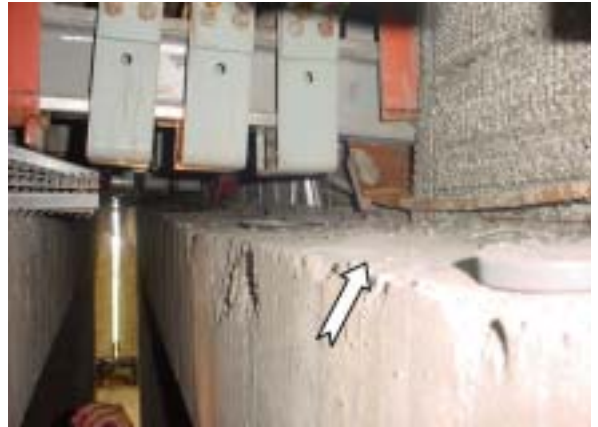
圖4.20 鋼箱底部澆置不實將因振動過大而使伸縮縫破壞
