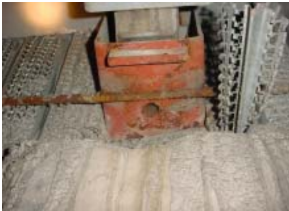
圖4.21 安裝位置不當致鋼支承箱懸空
