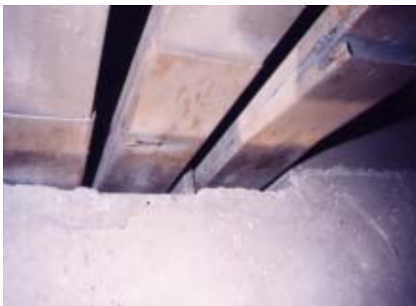
圖4.17 滑動控制系統鋼梁焊接處開裂
