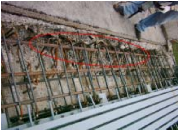
圖4.45 進橋版側鬆動砂石未徹底清除
