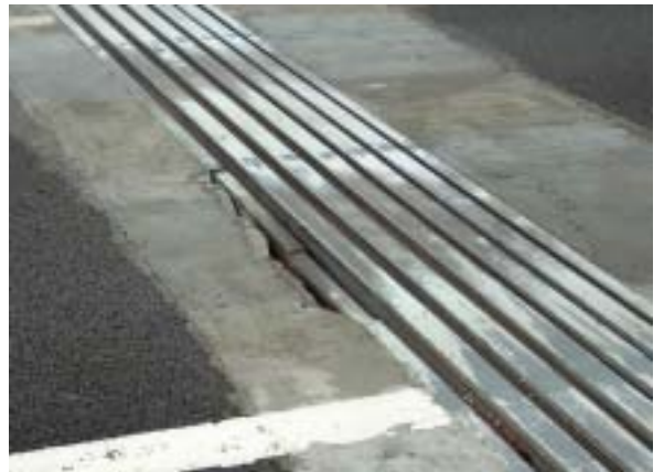
圖4.16 錨碇混凝土破壞致使邊樑斷裂
