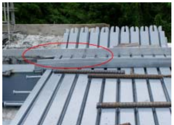
圖4.50 伸縮縫安裝向一邊偏斜
