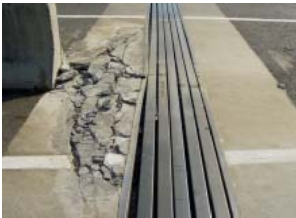
圖4.29 無收縮混凝土受撞擊破裂、伸縮縫邊樑彎曲
