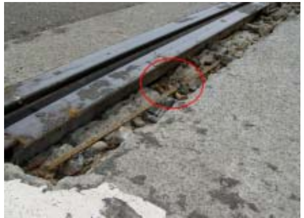
圖4.8 錨碇剪力釘斷裂脫落
