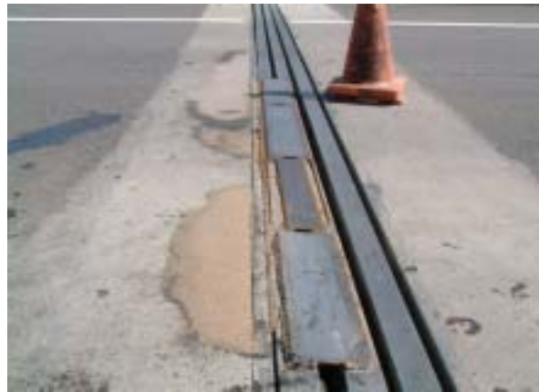
圖4.28 以鋼板焊接修補但仍持續開裂
