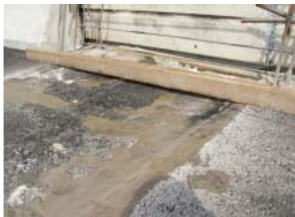
圖4.34 預留槽夯填不實凹陷切割線在凹陷斜面上
