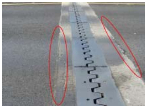
圖3.3 錨碇混凝土裂縫較輕微者
