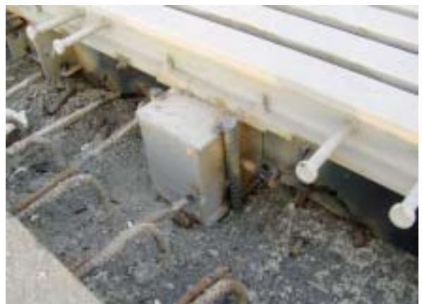
圖4.42 預留槽深度不足支承箱貼近拖座影響混凝土填滿及其強度
