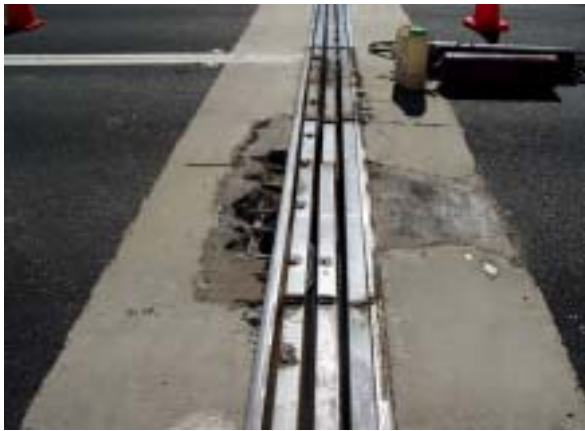
圖4.25 錨碇混凝土修補後再次破裂進而造成鋼梁斷裂
