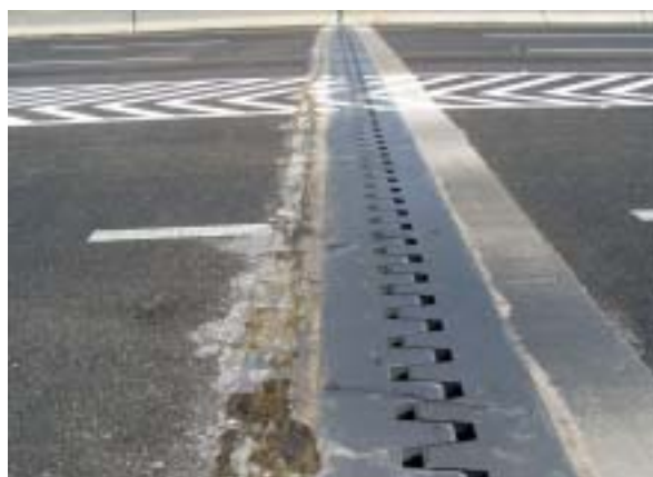
圖3.4 錨碇混凝土裂縫較嚴重者
