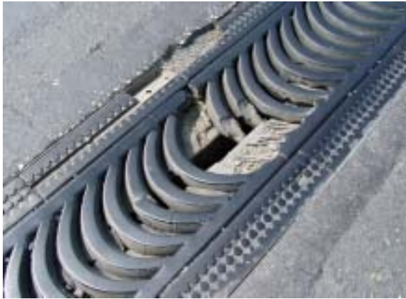
圖4.5 橡膠板剝離、預埋鋼板外露
