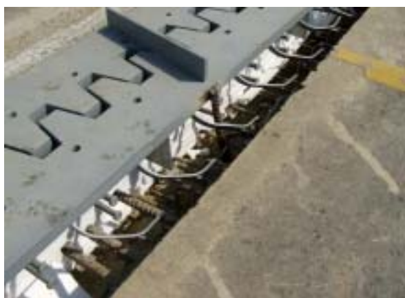
圖4.60 預留槽寬度不足，將錨碇桿彎折，填縫保麗龍板又將預埋鋼筋包住
