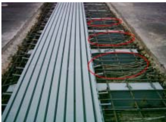
圖4.57 支承箱間橋面版預留鋼筋未予綁紮妥善補強筋配置鬆散
