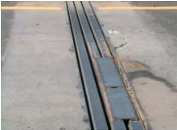
圖4.27 鋼梁斷裂以鋼板焊接修補
