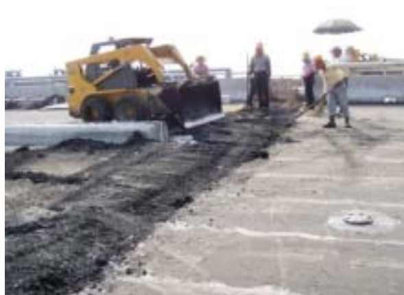
圖4.33 填充砂包未鋪平AC鋪設拱起
