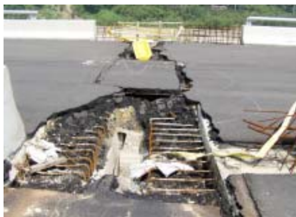
圖4.36 預留槽底部間隙未處理好使填充材料流失AC面層受破壞
