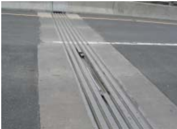
圖4.15 伸縮縫中間鋼梁斷裂
