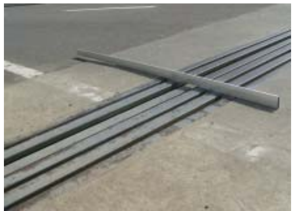
圖4.18 支承墊脫落致使鋼梁下陷
