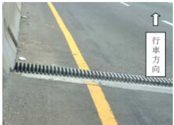
圖4.10 順車行方向前側伸縮縫陷落對行車造成嚴重威脅
