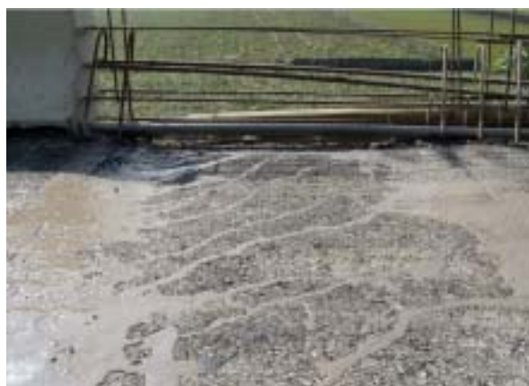
圖4.35 預留槽夯填不實凹陷情形
