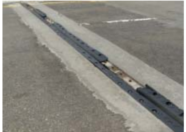
圖4.2 螺栓銹蝕或剪斷橡膠板撕裂脫離
