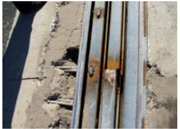
圖4.26 鋼梁斷裂損壞情形
