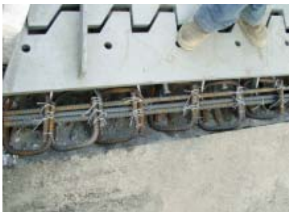
圖4.59 預留槽寬度及深度不足，補強鋼筋隨意綁紮
