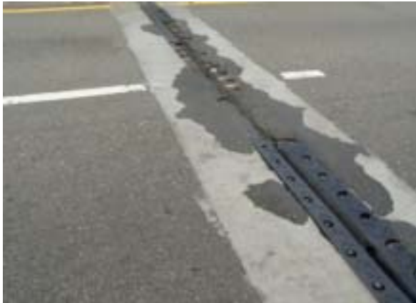
圖4.1 錨碇混凝土開裂破碎橡膠板脫落
