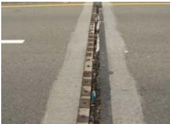
圖4.3 錨固件鬆動橡膠被拉斷破裂脫落圖
