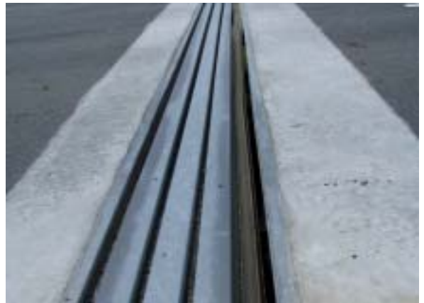
圖4.22 邊樑縫距異常橡膠脫落
