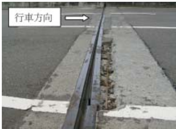
圖4.7 錨碇混凝土破裂伸縮縫鋼梁斷裂
