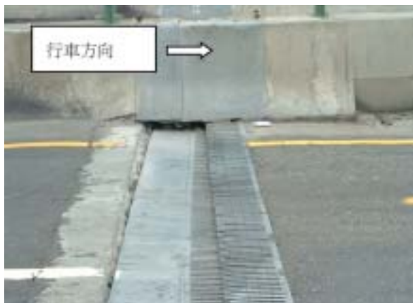
圖4.9 豎齒型伸縮縫錨碇鐵件斷裂齒鋼板陷落
