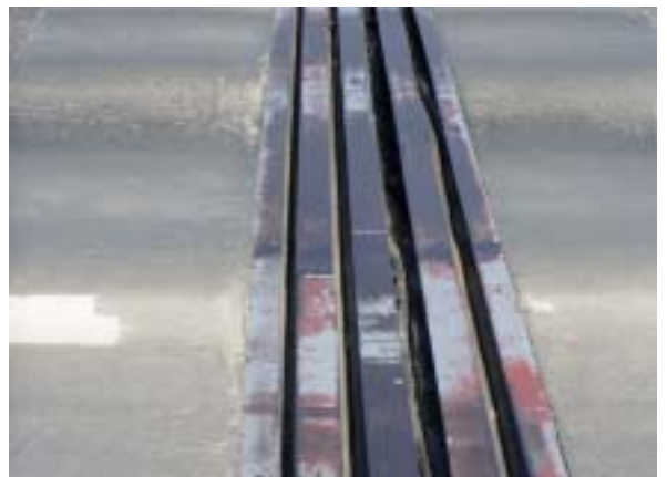
圖4.30 橡膠破裂脫落
