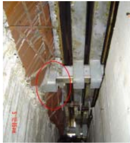
圖4.52 伸縮縫安裝偏一邊支承未坐落在混凝土拖座上
