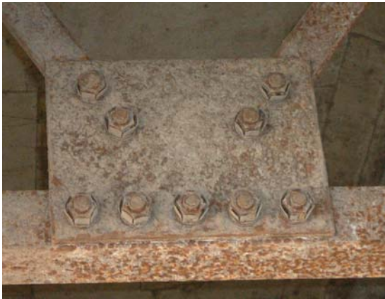
照片 9-1 施工前螺栓生鏽情形
