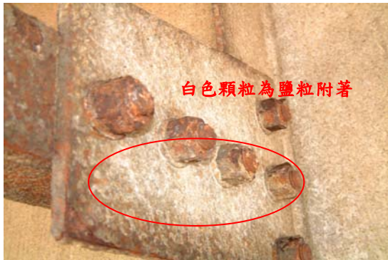
照片 9-5 施工前螺栓生鏽照片
