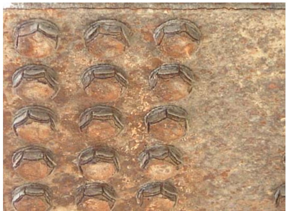
照片 9-2 施工前螺栓生鏽情形
