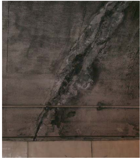
圖 6 案例隧道襯砌開裂滲水潮濕，並有白華產生
