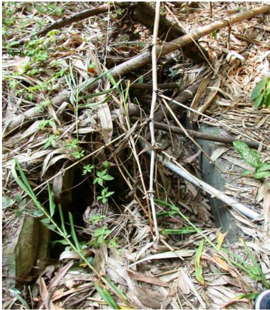
圖 5 案例隧道洞口排水設施堵塞情形
