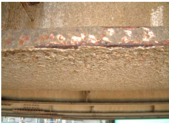
照片 9-3 施工前承接版生鏽情形
