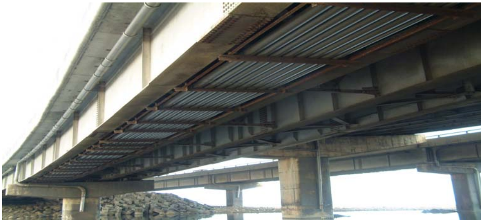
圖 2.2 林口高架橋修復前現況圖
