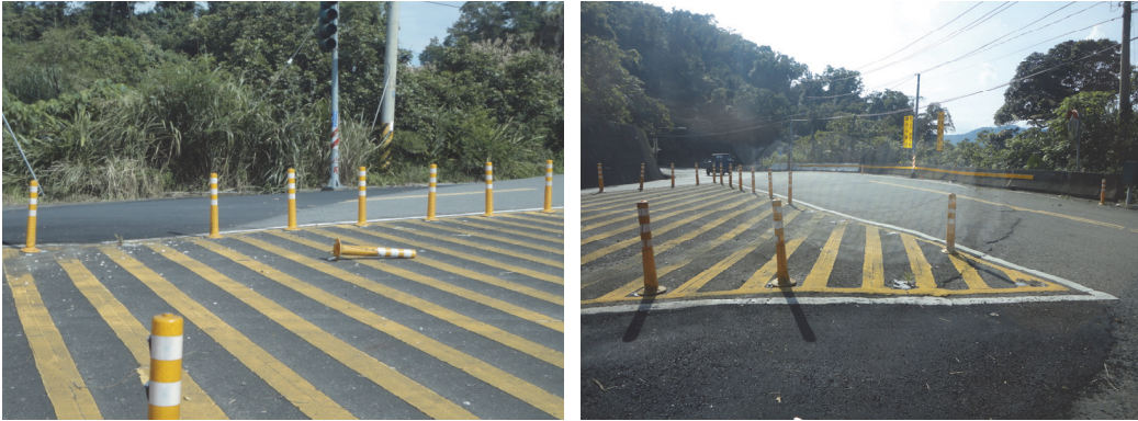
圖二十七 多根交通桿受損消失未補齊之例
