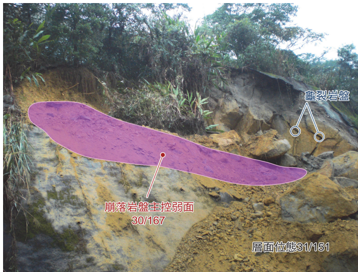
圖 3-4 崩落岩盤主控弱面
