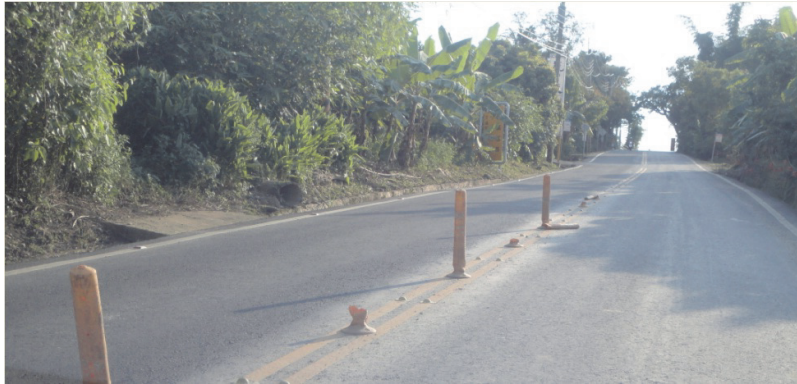
圖二十四 多根交通桿斷裂、折損與傾倒
