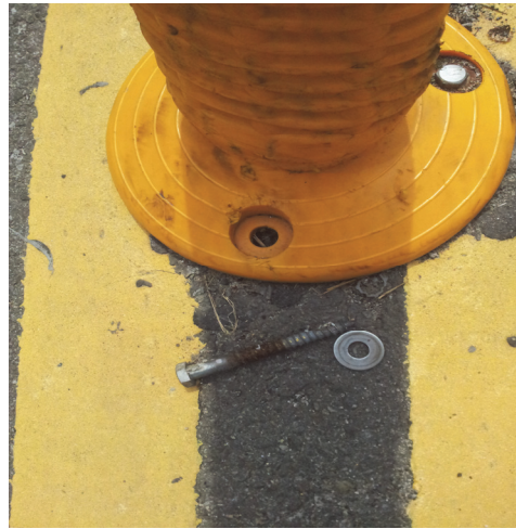
(b)螺栓脫落
