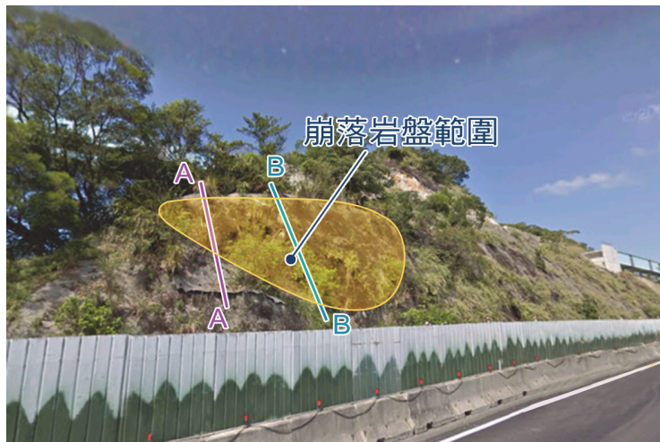
圖 3-1 崩塌岩盤範圍
