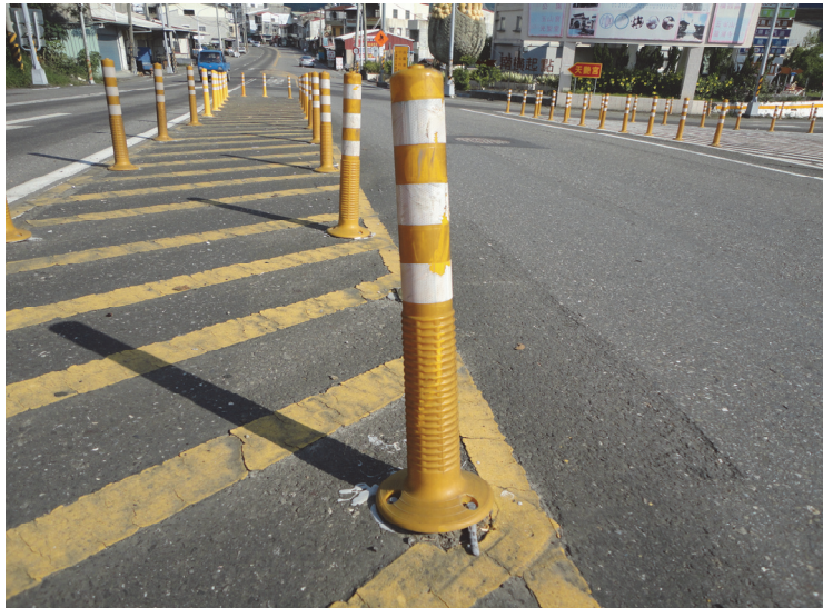
圖三十二 固定螺栓移位而致交通桿未能直立
