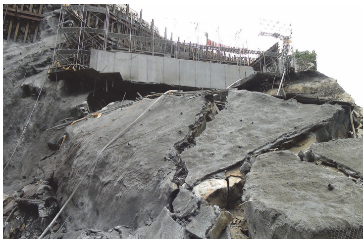
圖19 F2基座上邊坡3~4M厚之岩盤滑落
