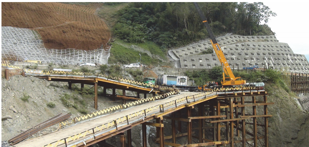
圖21 承包商打設施工鋼構台方式讓吊車及施工機具到達吊裝便道
