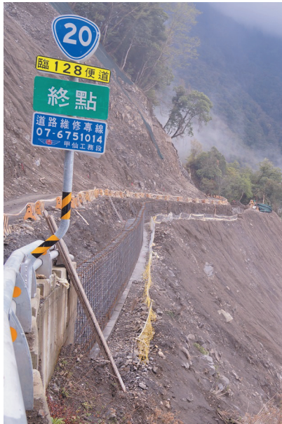
圖 13 中之關處目前施工上邊坡以自由型格噴草植生，下邊坡設 RC 擋土牆
