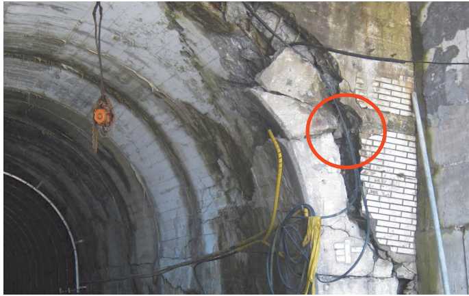
圖 22 大關山隧道東洞口建議原隧道已破裂段予以打除重建，調查破裂段可能之原因，若有需補強如補設地錨或刷坡者，請考量
