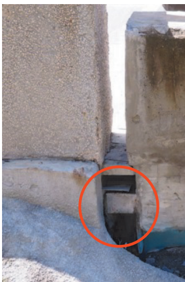
圖 30 橋台耳牆（翼牆）所殘存甘蔗板等雜物，影響大梁伸縮功能
