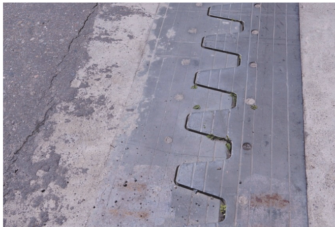
圖 29 利稻橋 A2 橋台伸縮縫有受到擠壓現象
