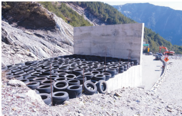
圖 24 施工中假隧道上方廢輪胎，建議調整為非平面，以利自然重力滾落，不致堆積於假隧道上方，若有堆積過多宜清除
