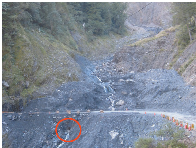
圖 15 武雄橋本路段野溪集水區上游崩塌，土石堆積，造成溪床淤高，沖毀橋梁；上邊坡受雨水沖刷而滑動；目前採用過水路面，二支涵管斷面不足，容易遭受土石堵塞而溢流損壞
