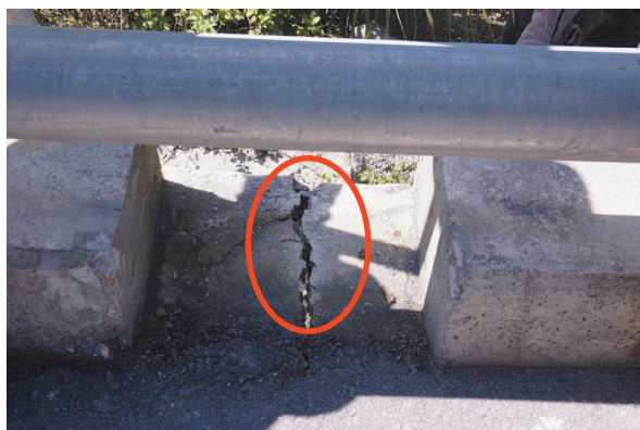
圖 31 引道路面及左側擋土牆有裂痕
