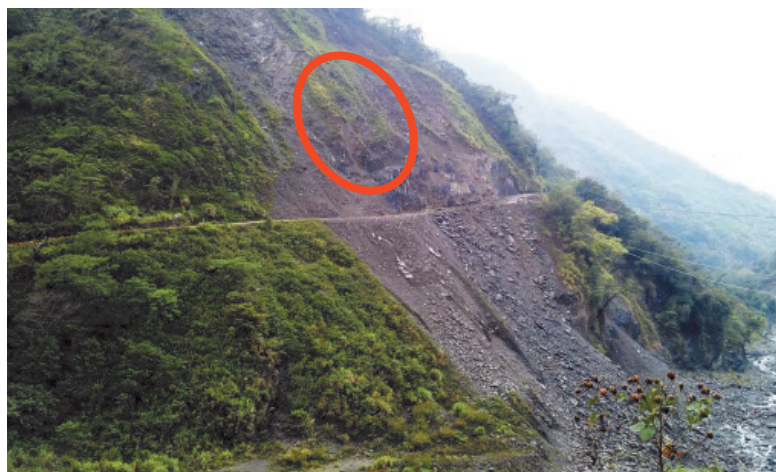
圖 5 唯金溪崩塌區 C 現況情形
