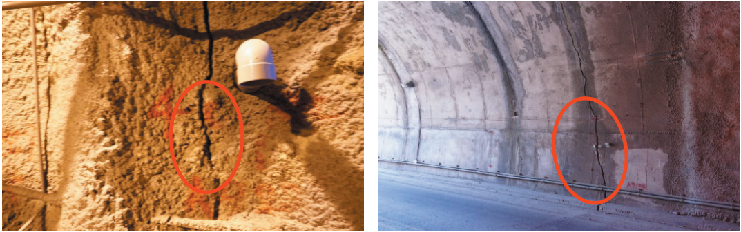
圖 35 隧道壁體襯砌開裂現象
