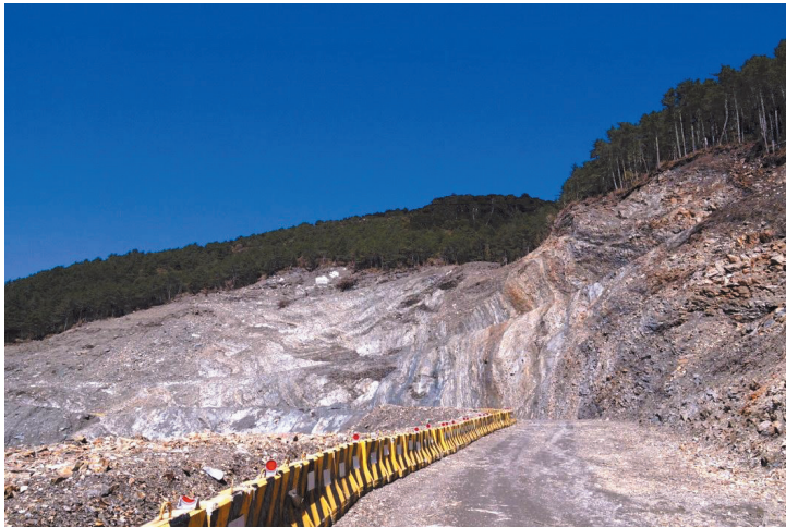
圖 25 台 20 線 146K+775 道路縱坡很陡峭，請注意有曲線路段之合成坡度等規定
