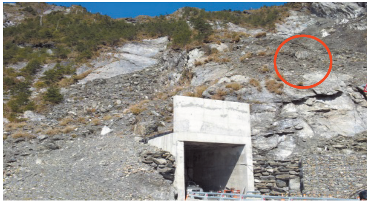
圖 23 隧道舊東洞口上邊坡受雨水沖刷而滑動，滑動土石造成隧道側壁受到側向推擠，混凝土襯砌變形破裂、龜裂損壞情形，導致隧道漏水嚴重，路面積水問題
