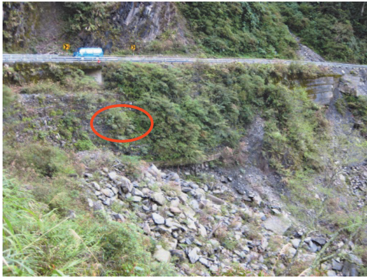
圖 6 台 20 線 124K+400 路基下陷路段，路基下邊坡以石籠駁坎方式，請檢討避免
