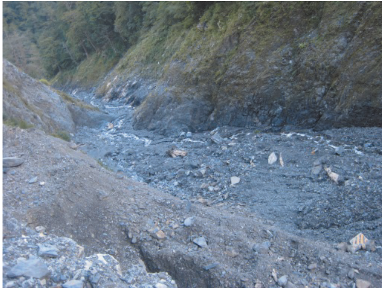
圖 16 武雄橋處河道變寬掏刷兩側道路下邊坡，造成路基下陷
