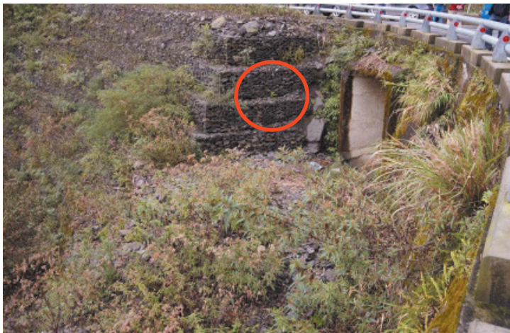
圖 7 台 20 線 124K+500 路基下陷路段，亦採用石籠駁坎，因石籠屬柔性構造物，直接以多層石籠護坡構築路基，易造成下陷
