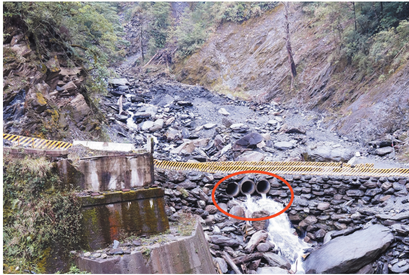
圖 17 進涇橋目前採用過水路面，三支涵管斷面不足，容易遭受土石堵塞而溢流損壞，造成路基流失
