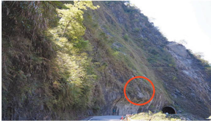
圖 37 松濤隧道東口引道建議就地形將山側鋼柱取消，於半隧道頂建構平行車行方向坎入岩壁之縱梁以支撐橫梁，或將斜頂橫梁嵌入半隧道岩體內或建支撐點予以支撐或由谷側鋼柱當為主要支撐
