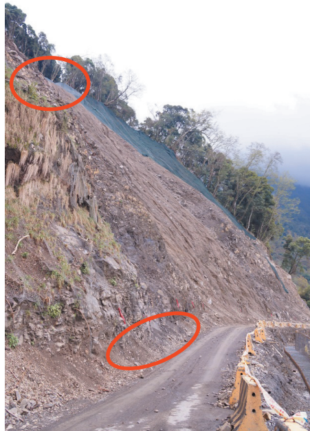
圖 12 上邊坡坡頂請注意完全於坡頂予以截水，坡面水於路基右側建排水溝截流，勿再流向左側下邊坡，縱洩溝應將水排除於路面外右側不宜沖入路基
