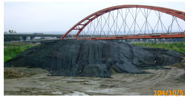
土方堆置未設置防塵網缺失改善
