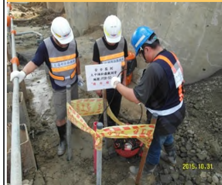
擋土支撐傾斜管量測
