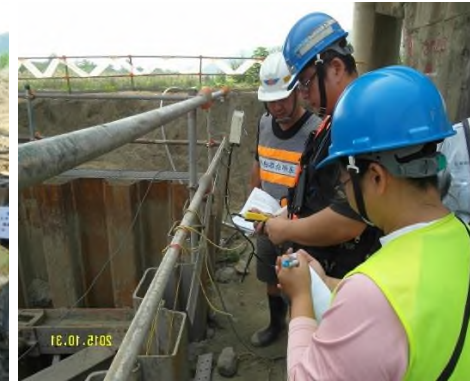
擋土支撐應變計量測
