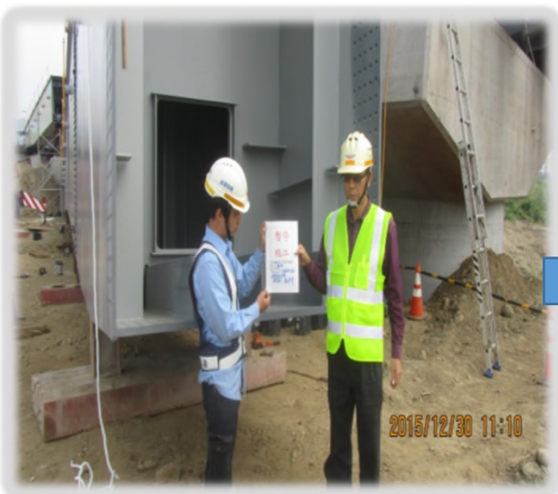
局限空間作業不合格有缺氧之虞 暫停施工
