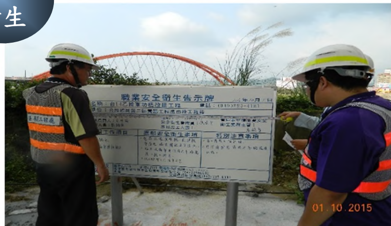
安全衛生告示牌檢查
