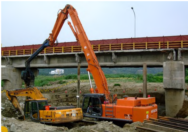
露天開挖作業未指派專人指揮監督
