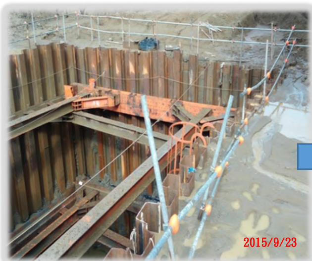
安全欄杆不合格有墜落之虞 暫停施工
