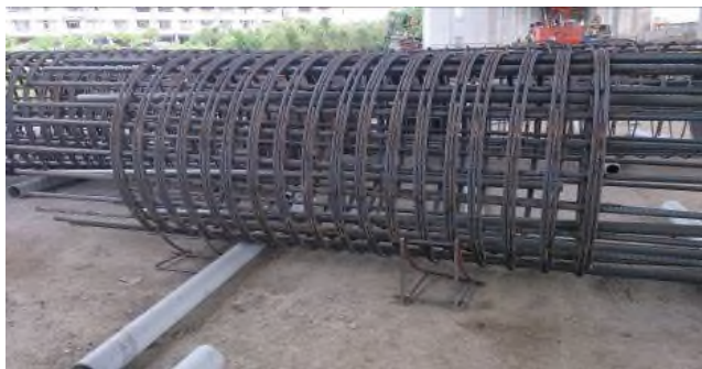
鋼筋籠未設置擋塊缺失改善
