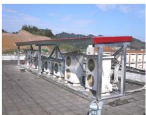
(圖 3 - 17 冷氣機應設置通風良好之場所並加蓋遮陽屋頂)
