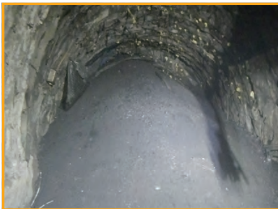
106 年 4 月 10 日南下線抽坍情形
