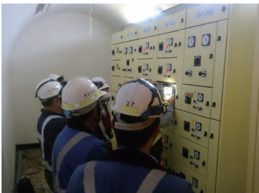
東岳隧道動力設備之單機測試
