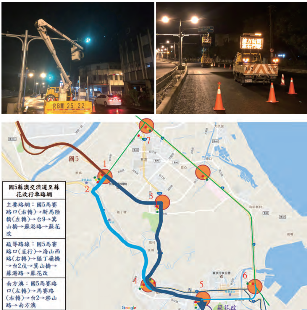
國5蘇澳交流道至蘇花改入口疏導路線牌面及號誌連鎖
