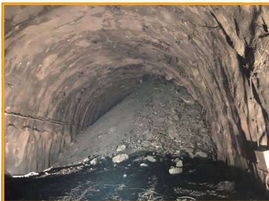
106 年 4 月 16 日北上線抽坍情形
