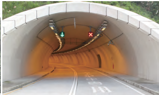
車道管制號誌
