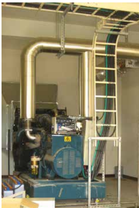
緊急柴油發電機(國道6號國姓二號機房)
