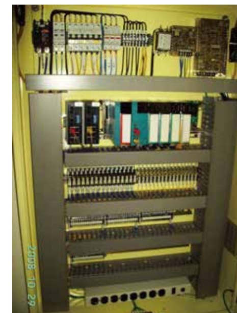
隧道監控系統(台64號觀音山隧道機房)
