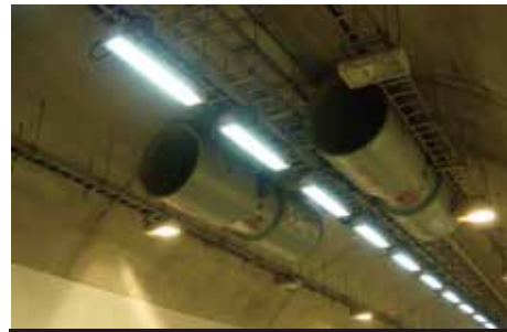
隧道噴流風機(國道5號雪山隧道)
