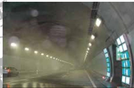
隧道水霧噴放(日本新東名高速公路)
