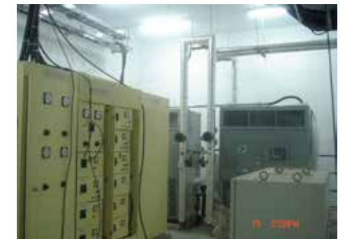
機房空調箱(國道5號雪山隧道)
