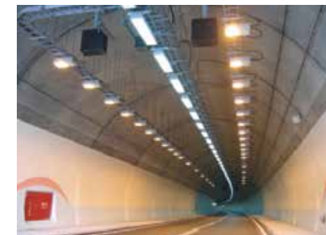
隧道照明(國道5號雪山隧道)
