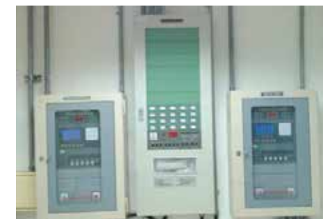
火警監控系統(台64號觀音山隧道機房)
