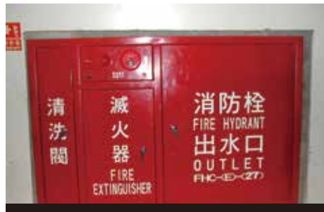
消防栓箱外部(國道5號雪山隧道)
