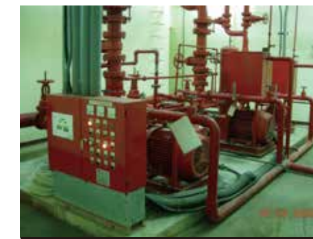
消防幫浦(北二高汐止隧道)
