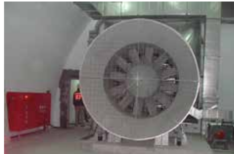
隧道軸流風機(國道5號雪山隧道)
