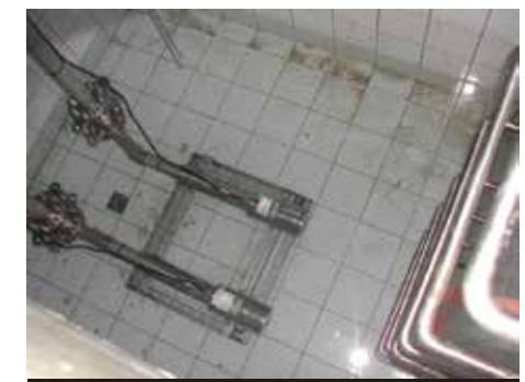
自來水配水池(國道6號國姓一號機房)
