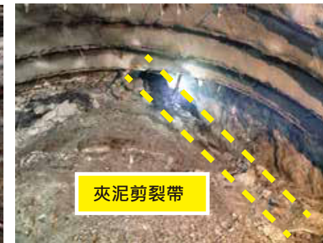
• 6k+156.4東側剪裂帶及初始坍落
