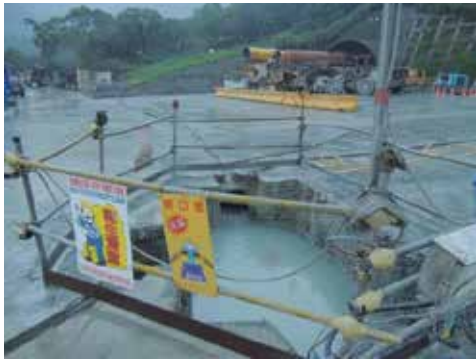
● 隧道內排水集中處理
