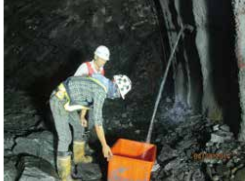
● 103.08.04 僅餘T701 RT側局部出水
