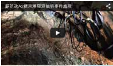
蘇花改A2標東澳隧道崩塌事件處理
