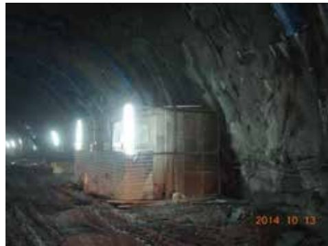
● 洞內供電設備
