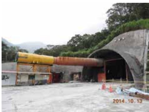
● 洞外大型送風機
