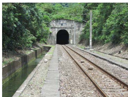
(b)永春隧道南口之排水渠道
