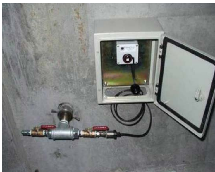
圖 3.6-5 雪山隧道營運階段之孔隙水壓與單點水量觀測儀器
