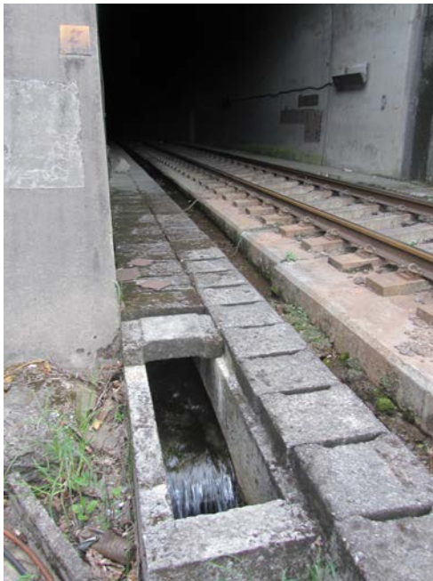
(i)新南澳隧道南口排水渠道
