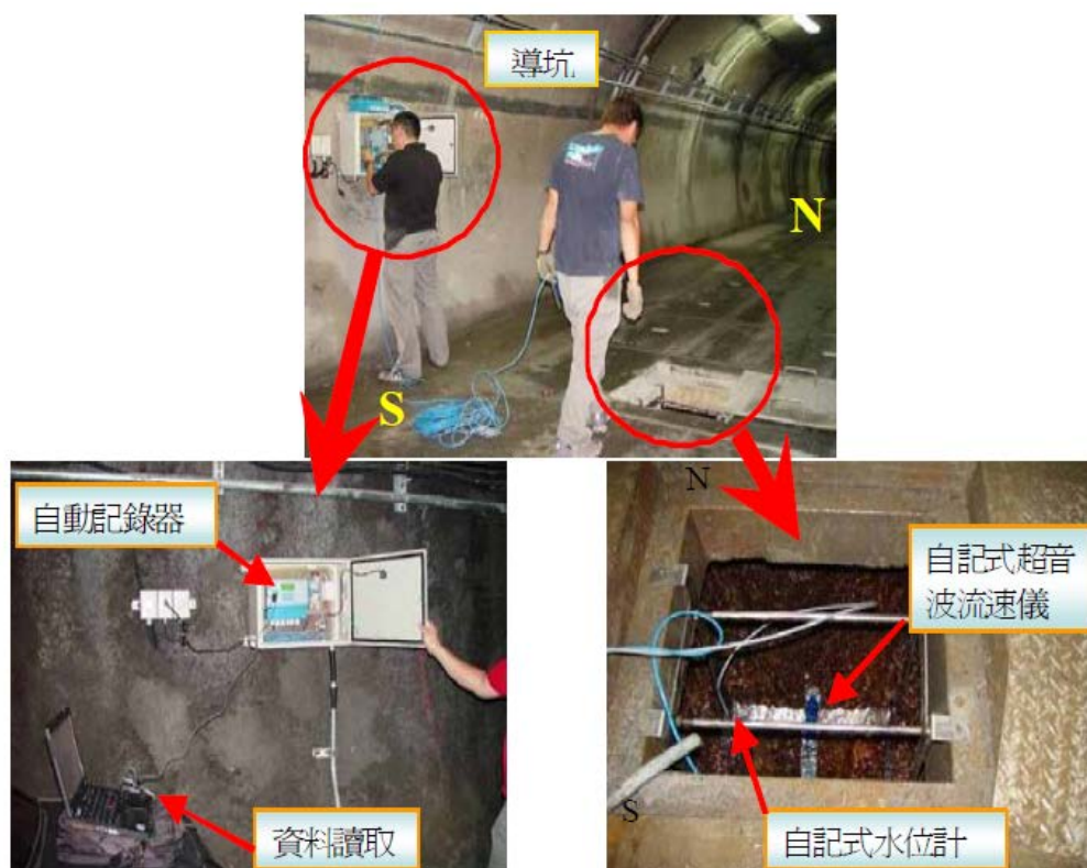
圖 3.6-6 雪山隧道營運階段之導坑出水量自動觀測記錄
