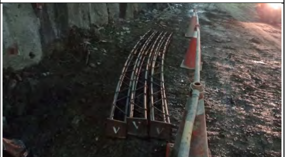
➤ A2 標北口工區：隧道內新進場材料堆置區,MA-威建 20:V 支堡(洞台)
