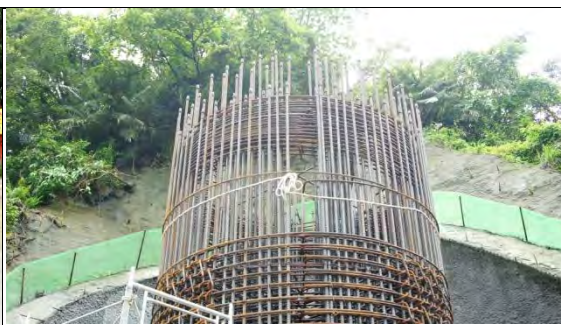
➤ A1 標永樂高架橋工區：PN7 井式基礎墩柱鋼筋與鋼筋母頭續接器
