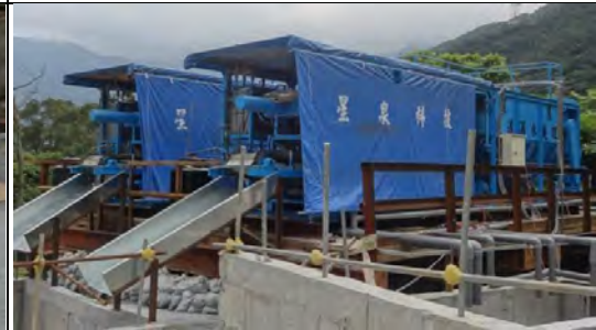
➤ A2 標南口工區：增設第二套水處理設備
