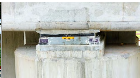
➤ A3 標東澳北溪河川橋工區：PN2 墩柱盤式支承(已填報使用)
