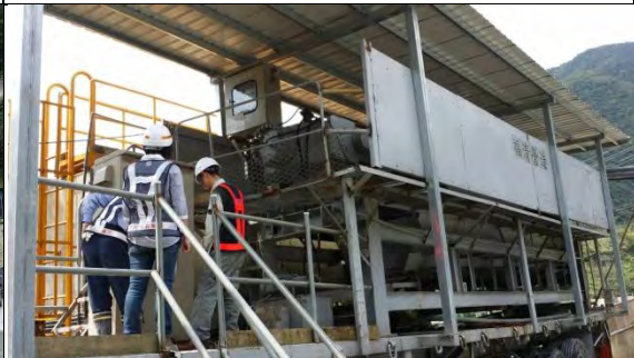
➤ A2 標工區：與查證人員巡訪東澳隧道南口污水處理裝置
