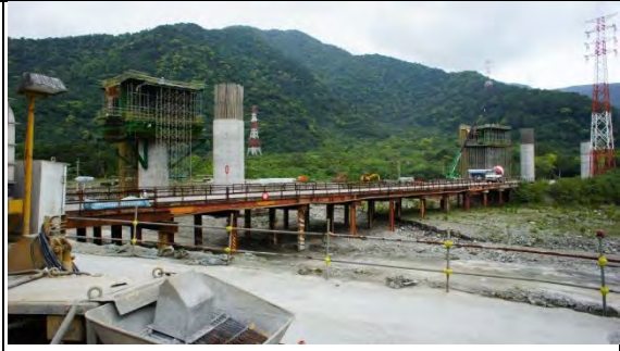
➤ A3 標工區：PS(N)12&PS(N)13 墩柱現況(PS12~13 柱頭板工程；PN12~13 墩柱工程)
