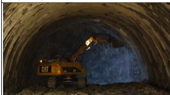
➤ A2 標南口工區：南下線隧道開挖面修挖作業(AA307 挖土機)
