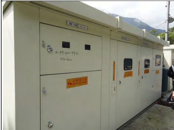
➤ C1 標南口：工區用電變電站
