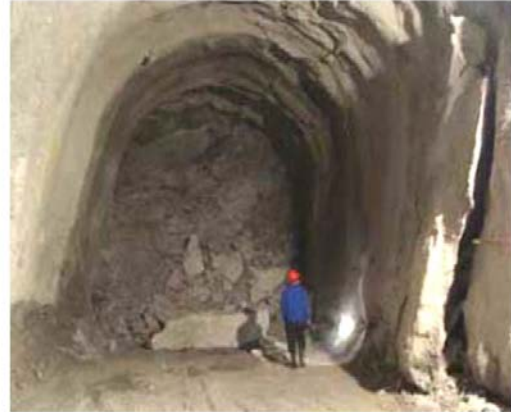
里程15K+472處板狀剝離破壞
