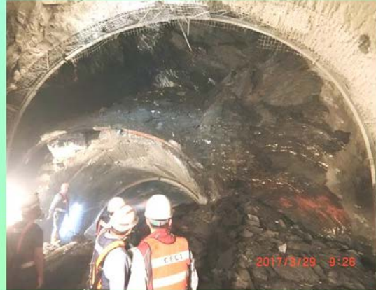
B2標7k+890通風管道3/29抽坍情形
