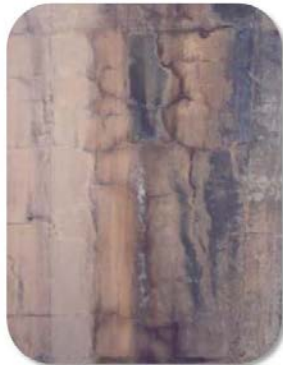
東部地區部分橋梁橋墩疑似骨材鹼反應造成混凝土劣化
