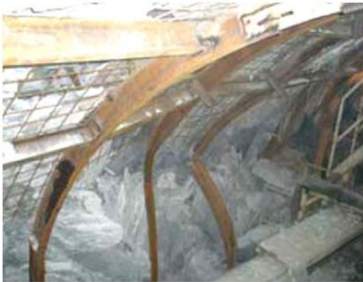
里程12K+454處鋼支保變形
