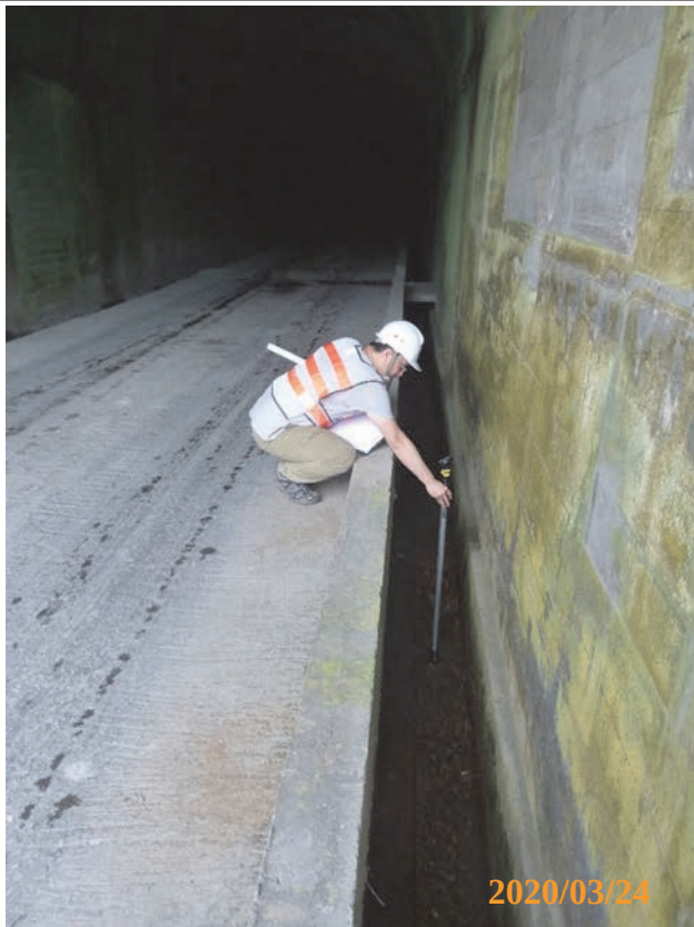
圖 3.3-1 觀音鐵路隧道北口渠道水流狀況
