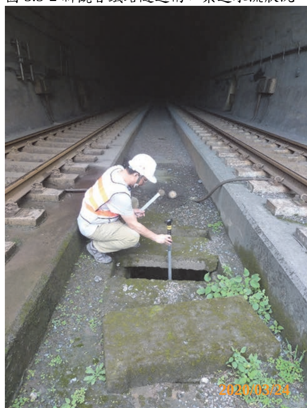
圖 3.3-4 新和平鐵路隧道北口渠道水流狀況
