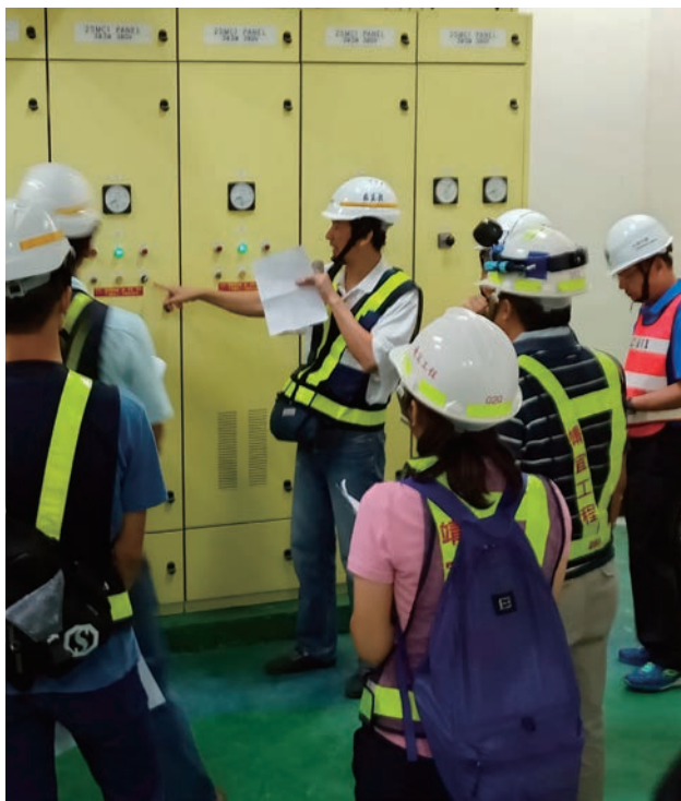
■ 東澳隧道低壓控制盤查驗
