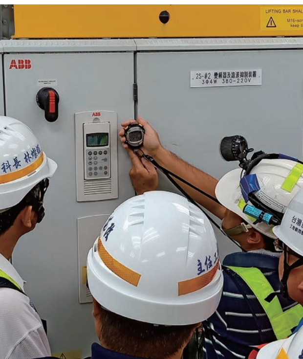
■ 東澳隧道軸流風機變頻器查驗
