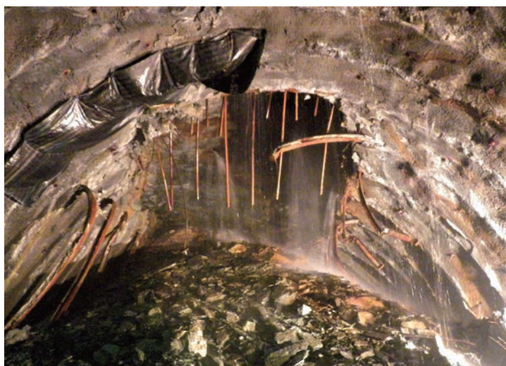
■ SS4 抽坍現場
