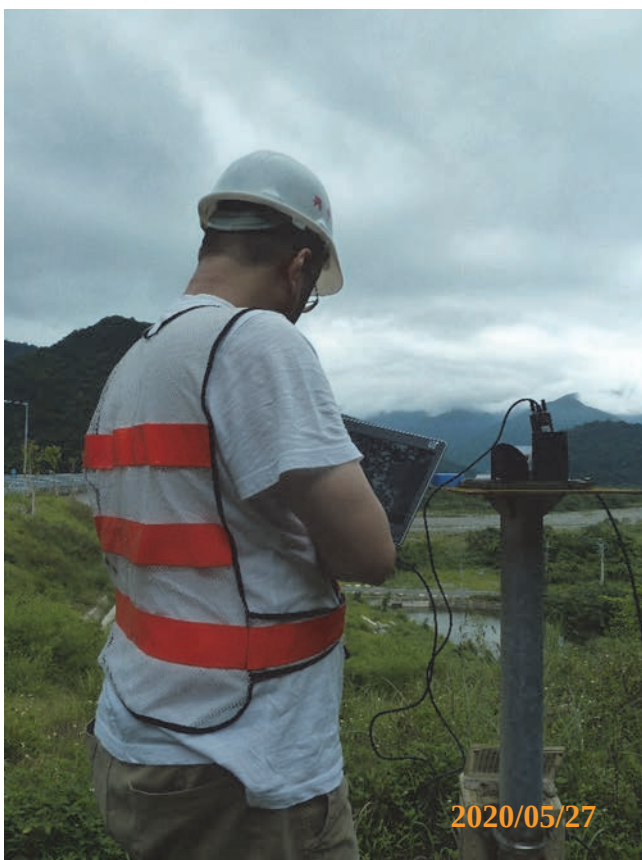
圖 3.2-1 觀音隧道北口自記式雨量站現況
