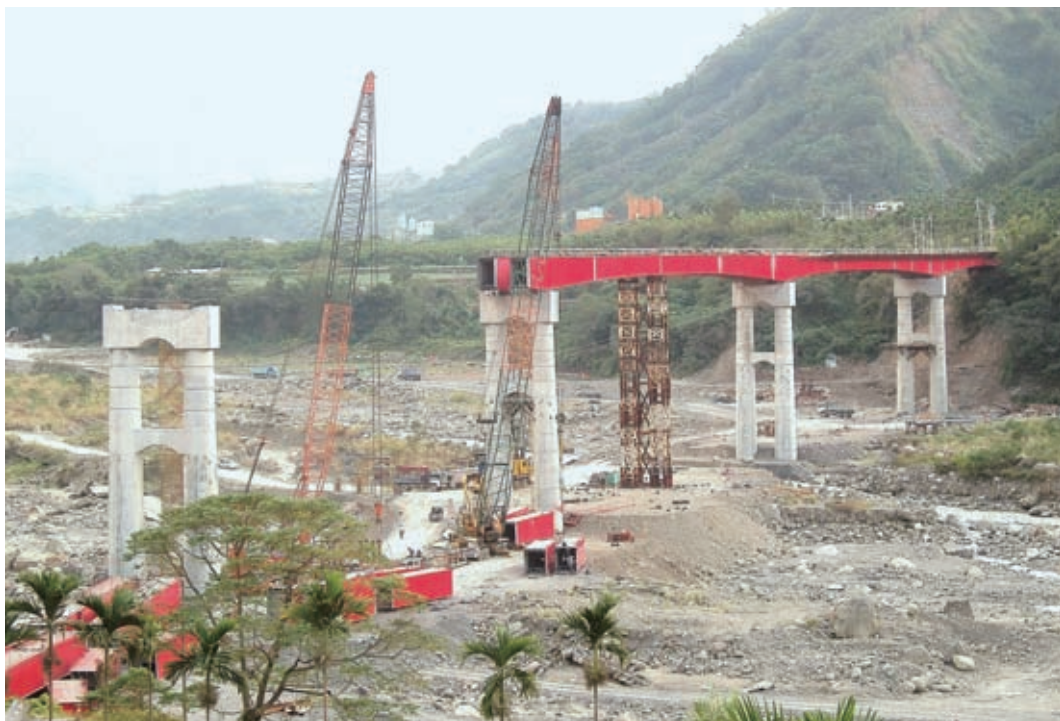
鋼架吊裝需避開汛期，在不平整的河床更需考量穩定度，避免吊裝過程倒塌，2005年11月
