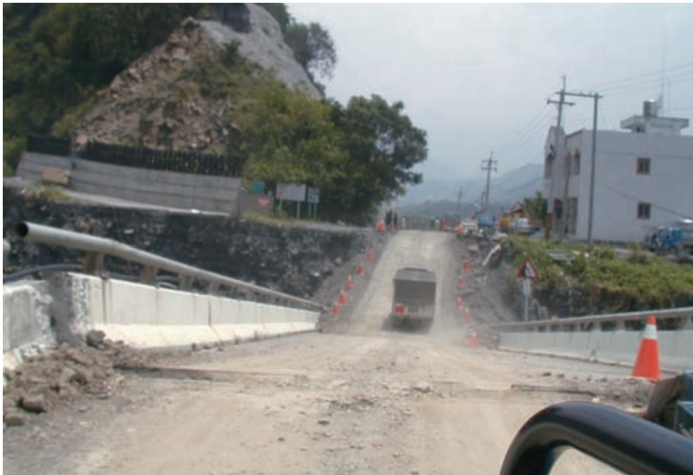
十八重溪橋的南側橋臺損壞下陷，2001年8月
