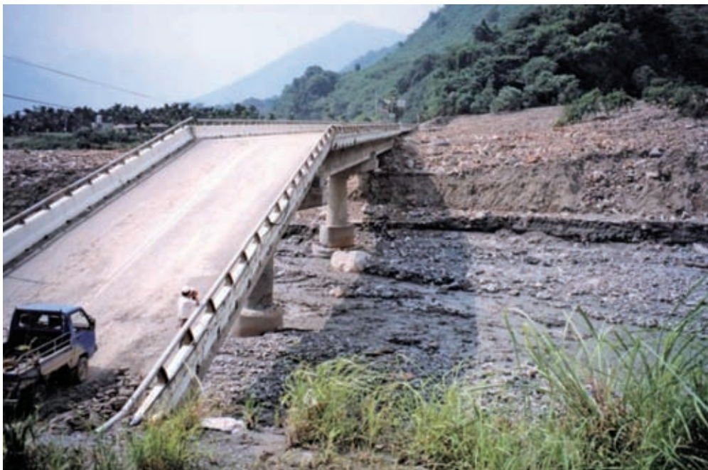
十八重溪橋因河道束縮、發生落橋，2001年8月
