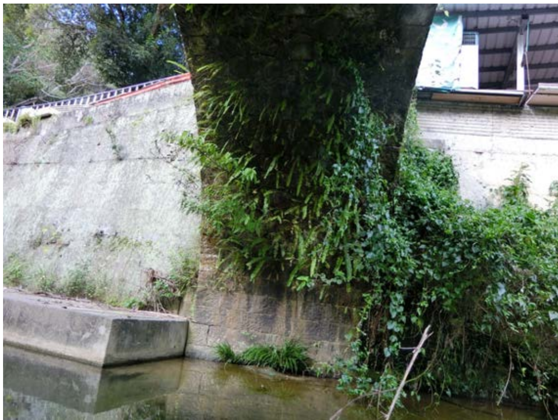
照片 3-8 砌石基礎直接坐落於河岸兩旁岩石上，石塊交錯疊砌
