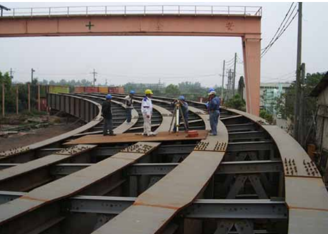
豐濱北橋橋梁施做人員為新橋進行假安裝 圖片 / 公路總局第四區養護工程處
