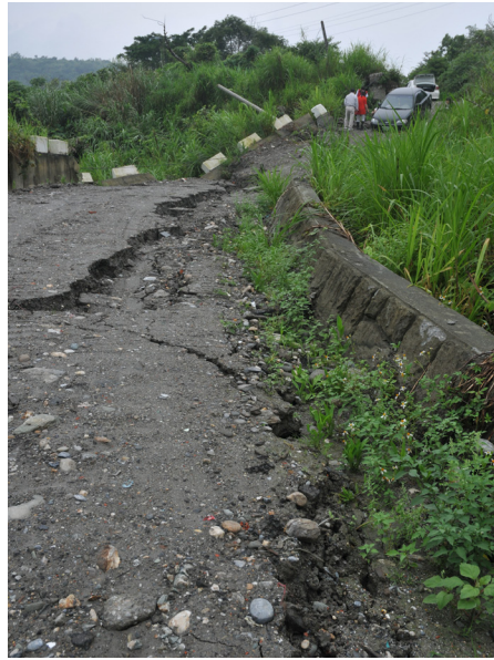
海岸山脈山區聯外崩塌的產業道路。
