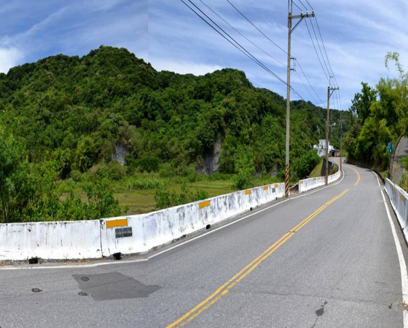
台 11 甲線光豐公路一直扮演著豐濱對外的重要交通要道，此為台 11 甲線增產橋。
