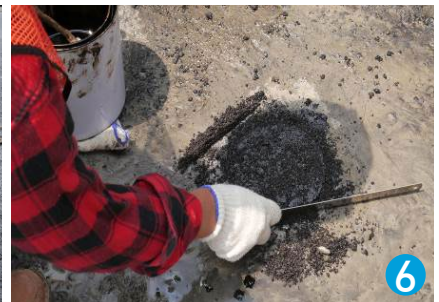
6 置入瀝青磚至鑽孔洞內，瀝青磚周圍縫隙以瀝青砂填補緊固，完成坑洞修補程序。
