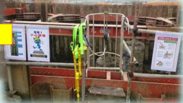
基礎坑上下設備
