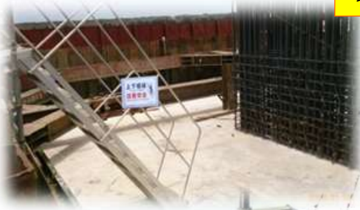
基礎上下設備
