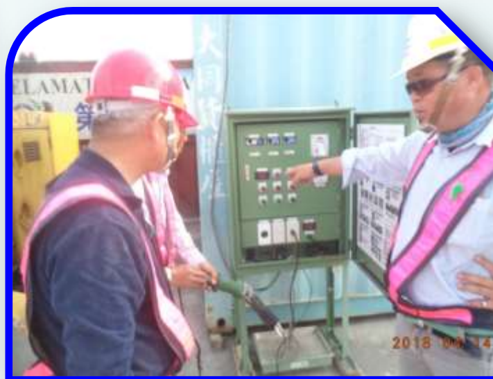
電氣設備接受漏電 檢測再進場
