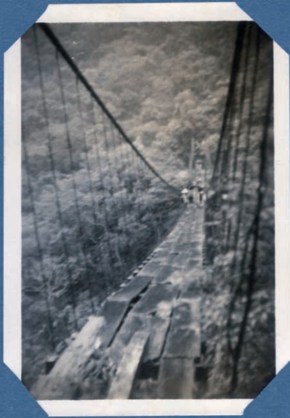
大曼吊橋西端，正面損壞情形
