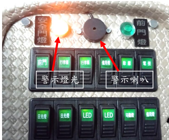
圖 4.4-7 緊急裝置防護遮蓋開啟像號警示燈
