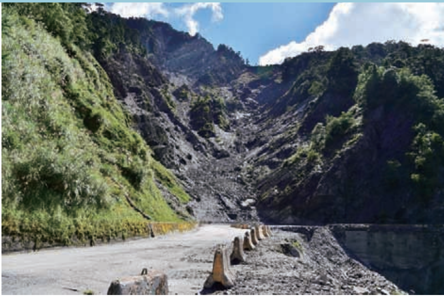
◀ 尚未修復通車的南橫路段，景況看來讓人怵目驚心。
