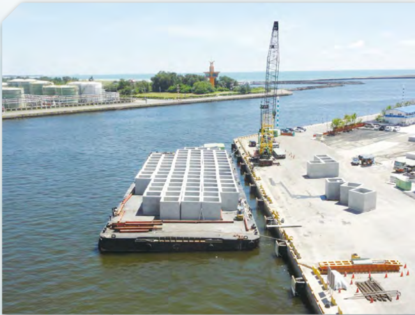
因島上缺乏施工資源，且為維護生態與環境，多數材料均先於臺灣本島港口施作後，再以平台船運至太平島。（圖片來源：交通部高速公路局， https://www.freeway.gov.tw/Upload/DownloadFiles/03 南沙太平島交通基礎整建工程竣工報告_第一篇_定稿 part1.pdf）
