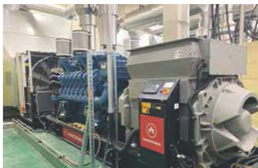
● 特高壓機房發電機測試
