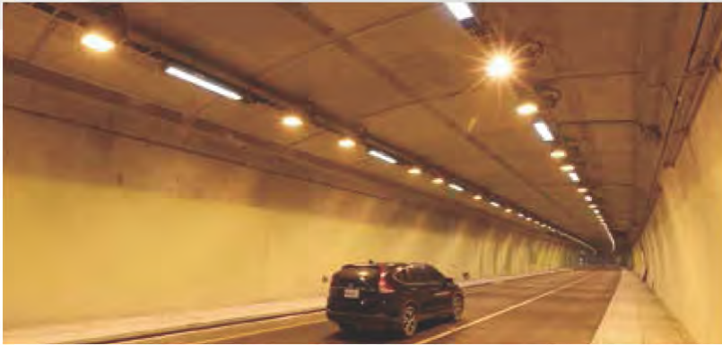
● 觀音隧道照明
