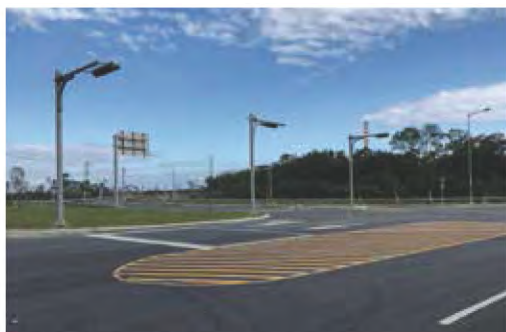
● B4 標銜接克尼布東路路口標誌架及號誌燈桿施作完成
