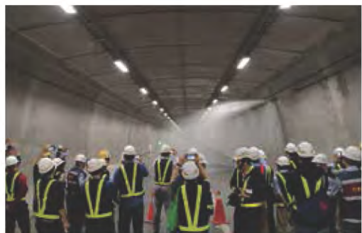
● 觀音隧道水霧系統全自動啟動噴灑
