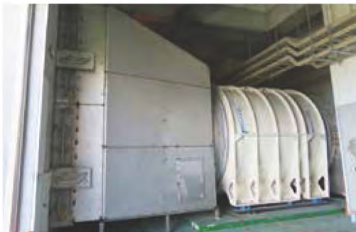
● 中仁隧道軸流式排煙風機
