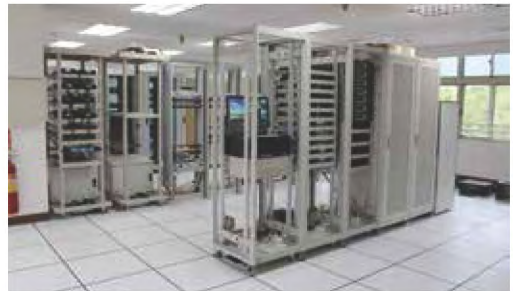
● 南澳交控中心機房設備配置
