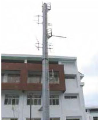
● 無線電鐵塔及天線實景
