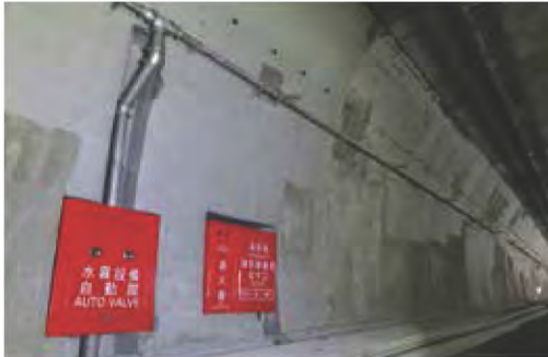
● 仁水隧道消防栓箱及水霧自動閥箱
