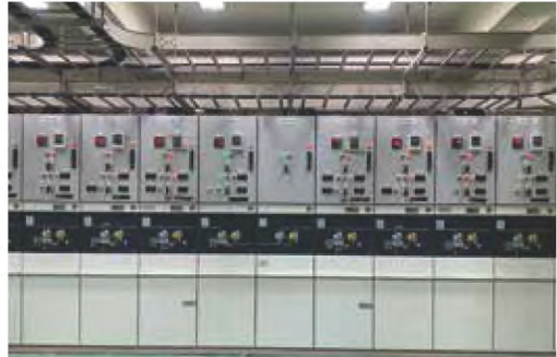
● 特高壓機房保護電驛
