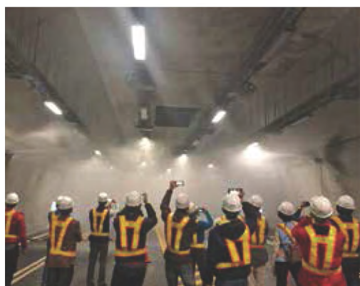
● 仁水隧道水霧系統測試情形
