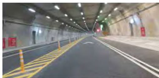
● 隧道內部區照明
