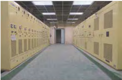
● 輔助機房高低壓配電盤
