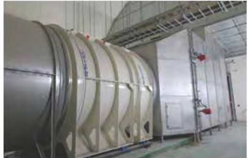
● 仁水隧道排煙軸流式風機
