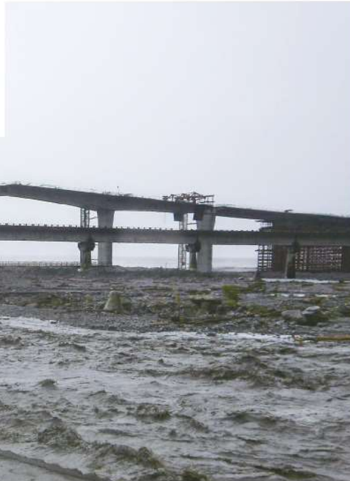
照1-21 溪水暴漲侵襲施工中的金崙大橋
