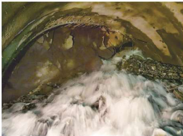
照0-103 北口南下線開挖時出現驚人的大量湧水
