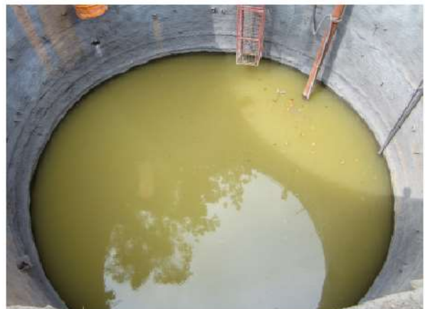
照0-44 井內湧水快速淹至深達1層樓的高度
