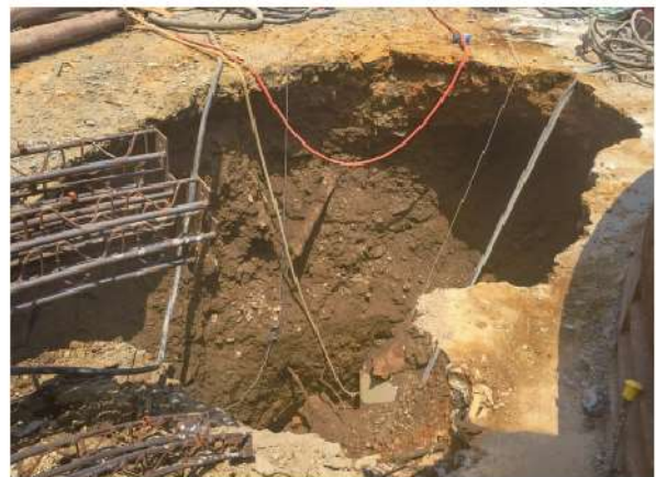
照0-48 井基外側出現地面坍塌
