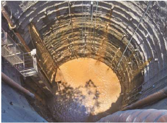
照0-45 井基內再次發生大量湧水情形
