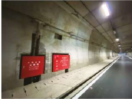
照0-01 水霧設備自動閥
