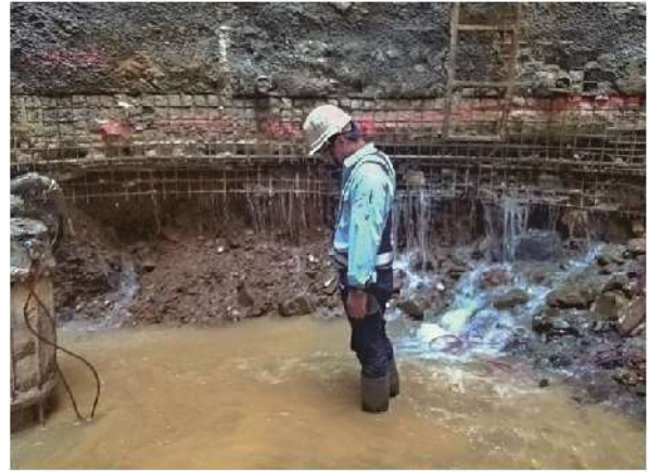
照0-46 井基內部發生土石抽坍的現象
