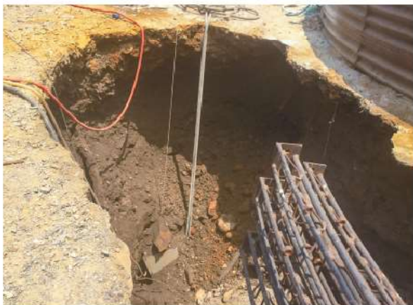
照0-47 井基外側出現地面坍塌
