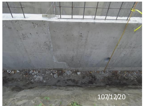
草本樣區四-12 月樣區因施工遭受破壞
