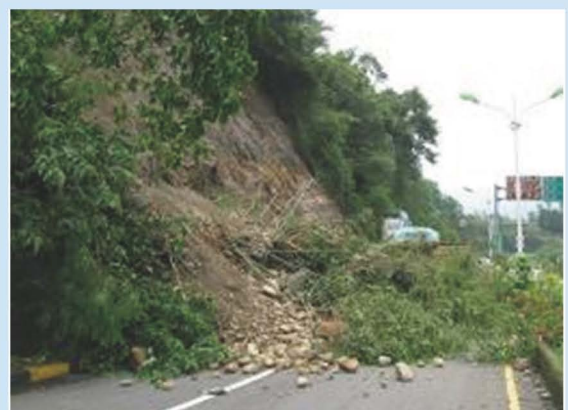
● 縣 133 線南投國姓 (5.5K) 邊坡坍方
