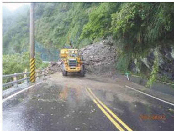
● 台 9 線南澳武塔 (140.2K~141.5K) 邊坡坍方
