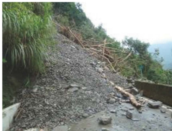
● 台 7 線巴陵至西村 (47K~60K) 邊坡坍方
