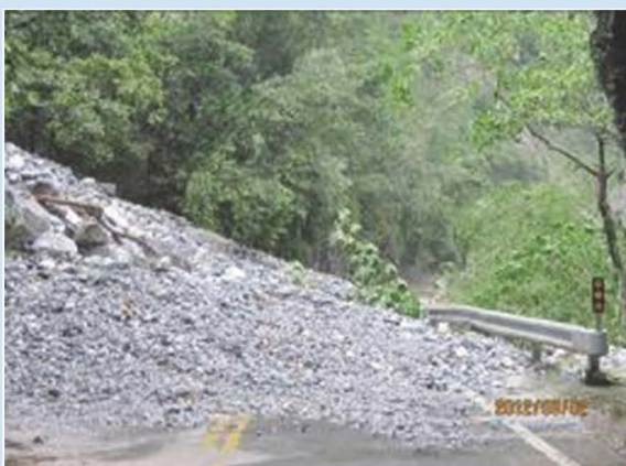
● 台 8 線秀林鄉溪畔 (179.9K~181.3K) 邊坡坍方
