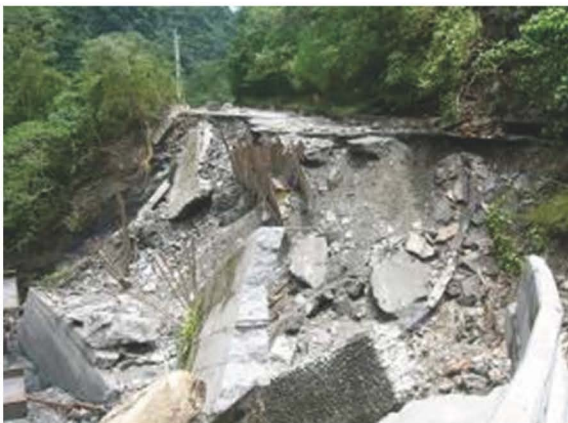
● 台 9 線南澳觀音 (147K) 路基流失
