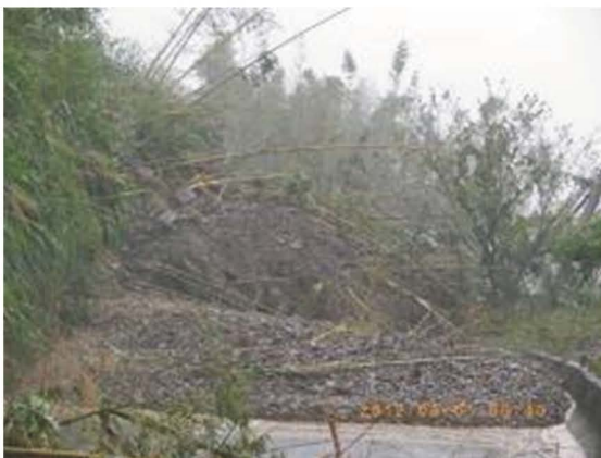
● 台 7 甲線大同四季 (18K~19K) 邊坡坍方
