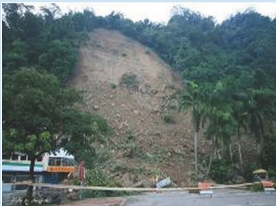
● 台 18 線番路觸口 (35K) 邊坡坍方
