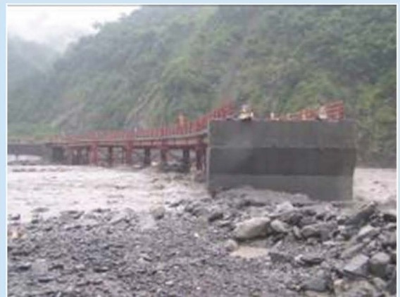
● 台 20 線撒拉啊塢橋 (95K) 橋梁引道流失
