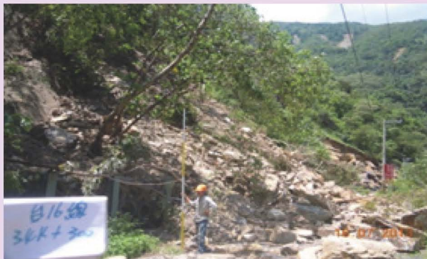
圖 7- 19 台 16 線 31K ~ 41K 道路邊坡坍方
