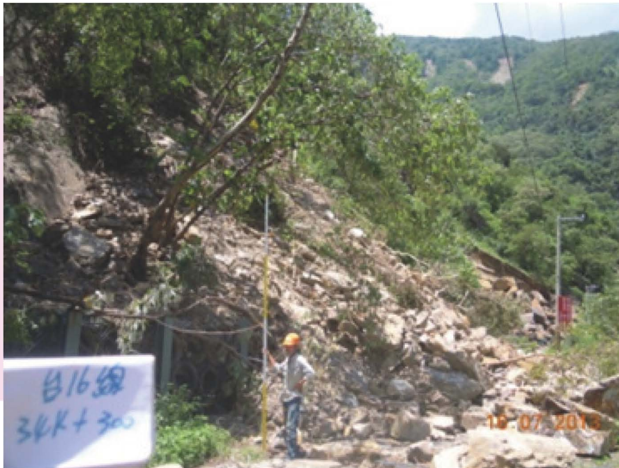
圖 6-4 台 16 線 31K ~ 41K 道路邊坡坍方
