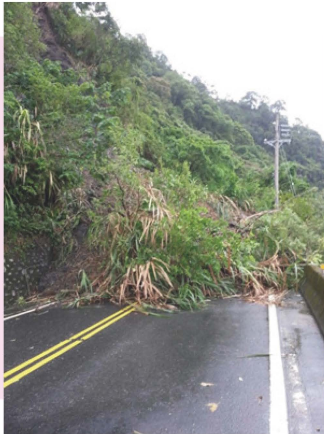
圖 6- 9 台 7 線 101K+500 宜蘭縣員山鄉崙埤邊坡坍方
