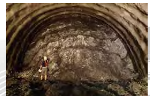
北口北上線-猴猗山斷層帶 4k+791.7大量出水
