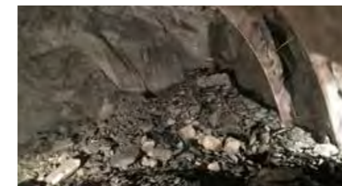
南口南下線-片岩區剪裂帶5k+789.4~787.4 東側坍落
