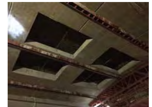
北上線排煙風門段
