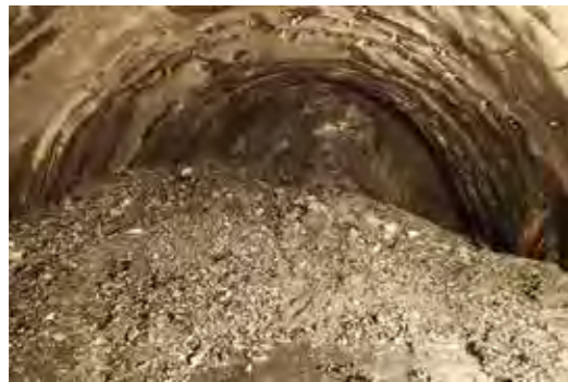
北口北上線-猴猗山斷層帶 4k+791.7大量出水
