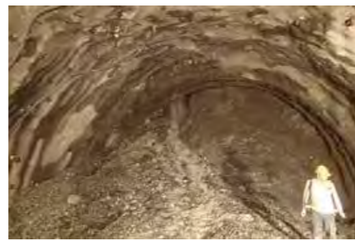
北口北上線-猴猗山斷層帶4k+795.9抽坍及大量出水
