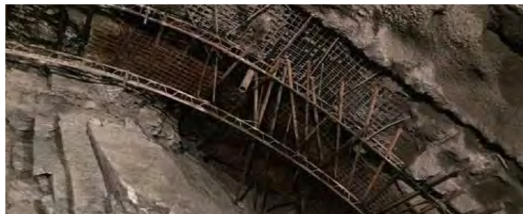
南口北上線-片岩區剪裂帶6k+109.2~085.1局部坍落
