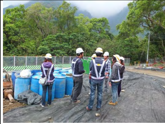
➤ C1 標工區實景：承商說明南口邊坡降挖及保護工程現場工料暫存及工作情形
