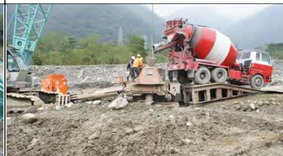
➤ A3 標工區實景：基樁工程作業機具(左：吊車；中：搖管機；右：混凝土預拌車)
