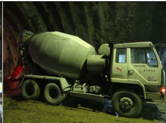
➤ C1 標南口：南下線隧道灌漿作業，使用運具 RENT-01 預拌混凝土車
