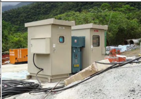
➤ A2標南口：臨時變電站高壓配電設備
