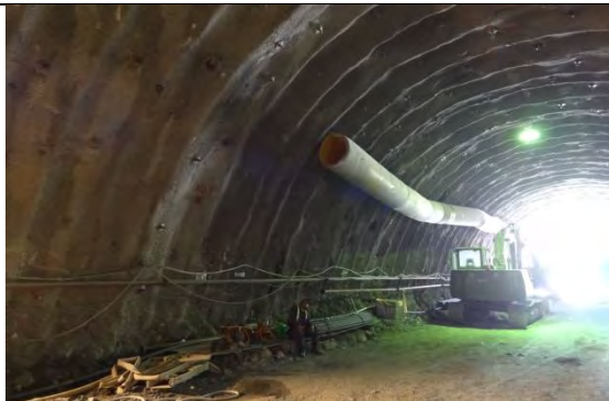
➤ C1 標南口北上線：通風及照明設備
