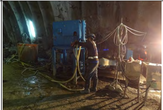
➤ C1 標南口北上線：隧道開挖及支撐工程-水泥漿液拌合設備
