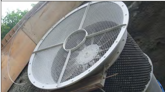
➤ A3 標工區：東岳隧道工程通風用風機
