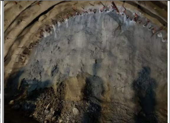
➤ C1 標南口北上線：隧道開挖及支撐工程-開挖面噴凝土封面
