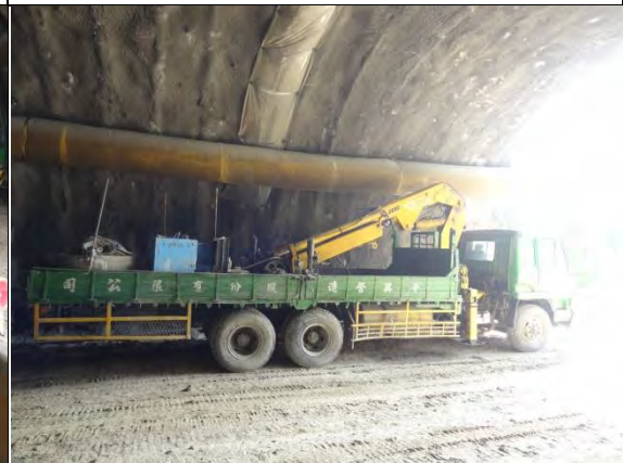
➤ C1 標南口：北上線隧道開挖作業設備載運使用運具-吊卡車 MC-08
