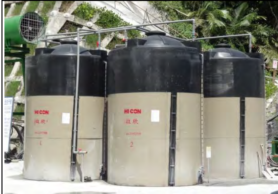
➤ C1 標南口：速凝劑桶槽(未啟用)
