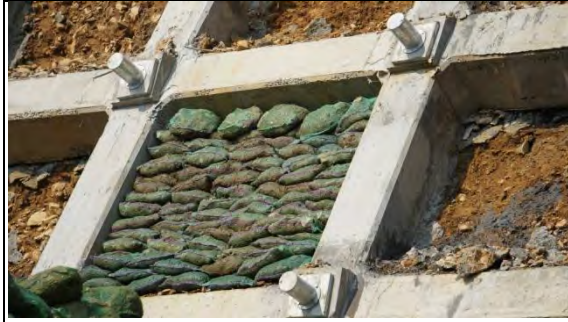
➤ A2 標工區：自由型格樑綠美化工程施作(客土植生袋裝填)
