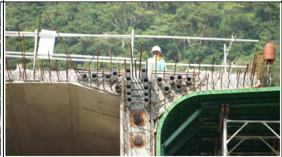
➤ A3 標工區：東澳北溪河川橋工區 PS1 墩柱(MA-樂志 05&06 預力套管&預力端錨)
