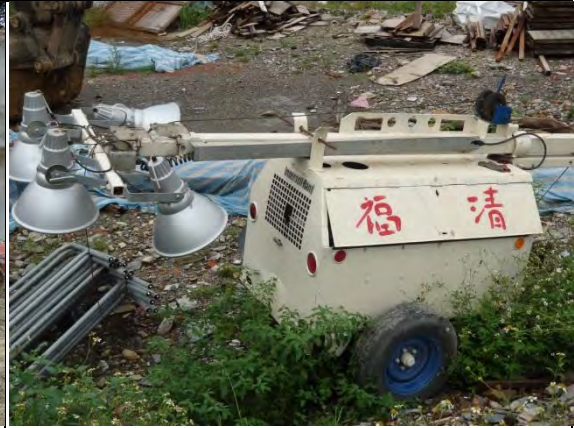
➤ A2 標工區(北口)： 隧道開挖作業照明機具，ME-福清 10 燈車
