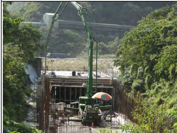
➤ C1 標南口：排水箱涵頂版、側牆混凝土澆置，使用機具 CP-01 混凝土壓送車
