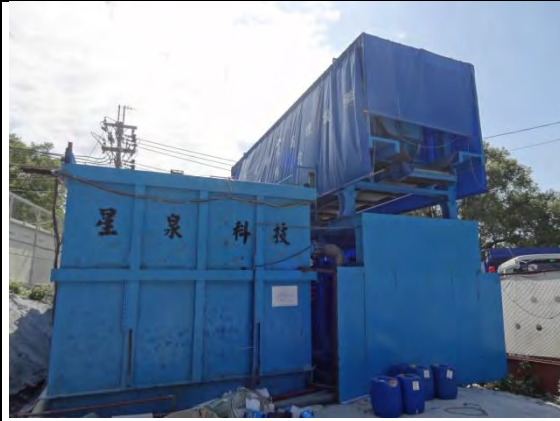
➤ C1 標南口：污水處理設備
