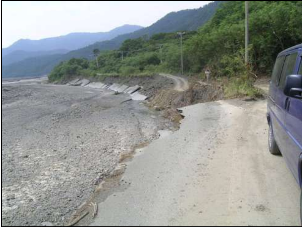
圖 2.1-12 枋山溪北岸南迴鐵路施工便道所見護岸基礎淘空後坍塌現象
