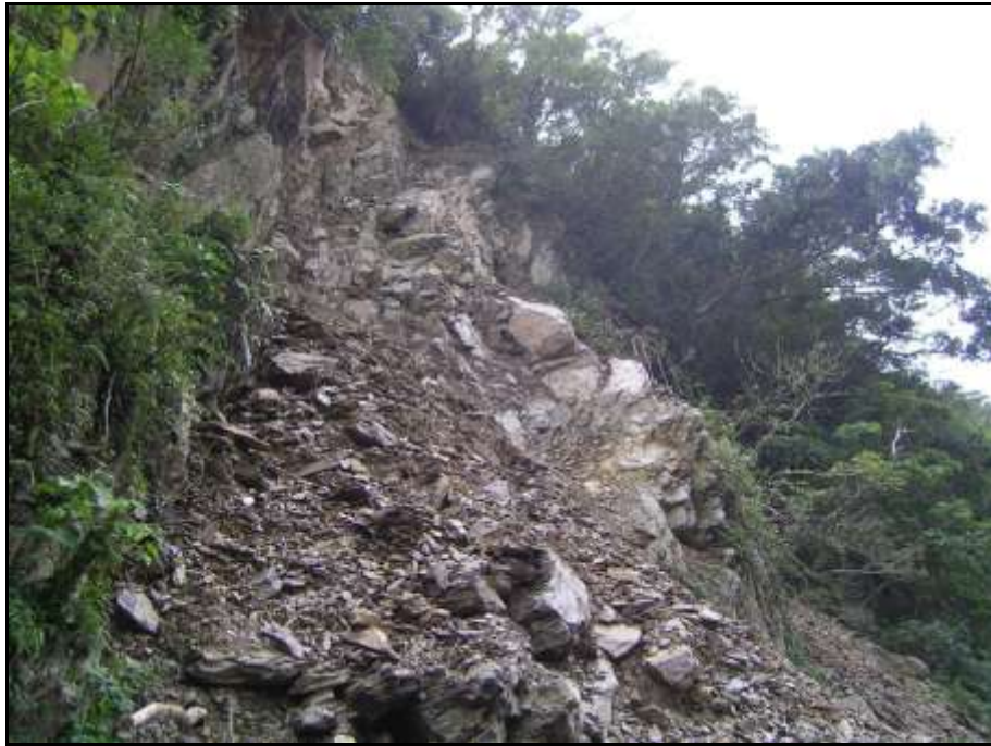
圖 2.1-9 枋山溪北岸南迴鐵路施工便道所見土石崩落現象
