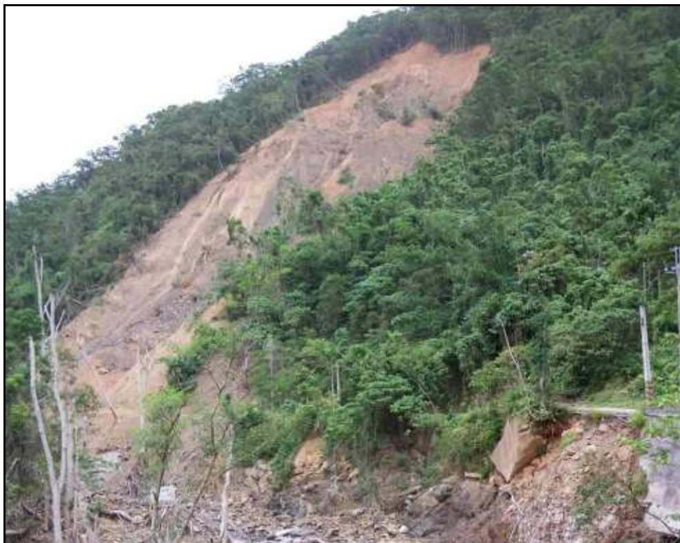
圖 2.1-5 安朔溪支流產業道路上邊坡之大面積坍滑現象
