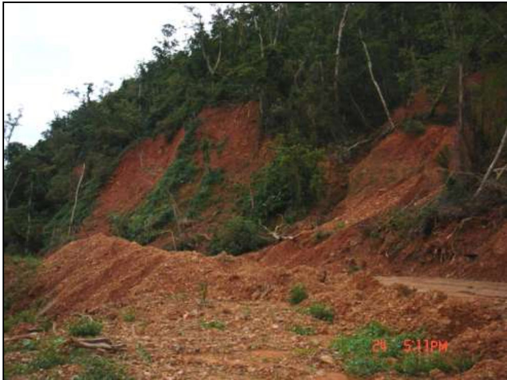
圖 2.1-4 安朔溪南岸南迴鐵路施工便道上邊坡之大面積圓弧滑動現象
