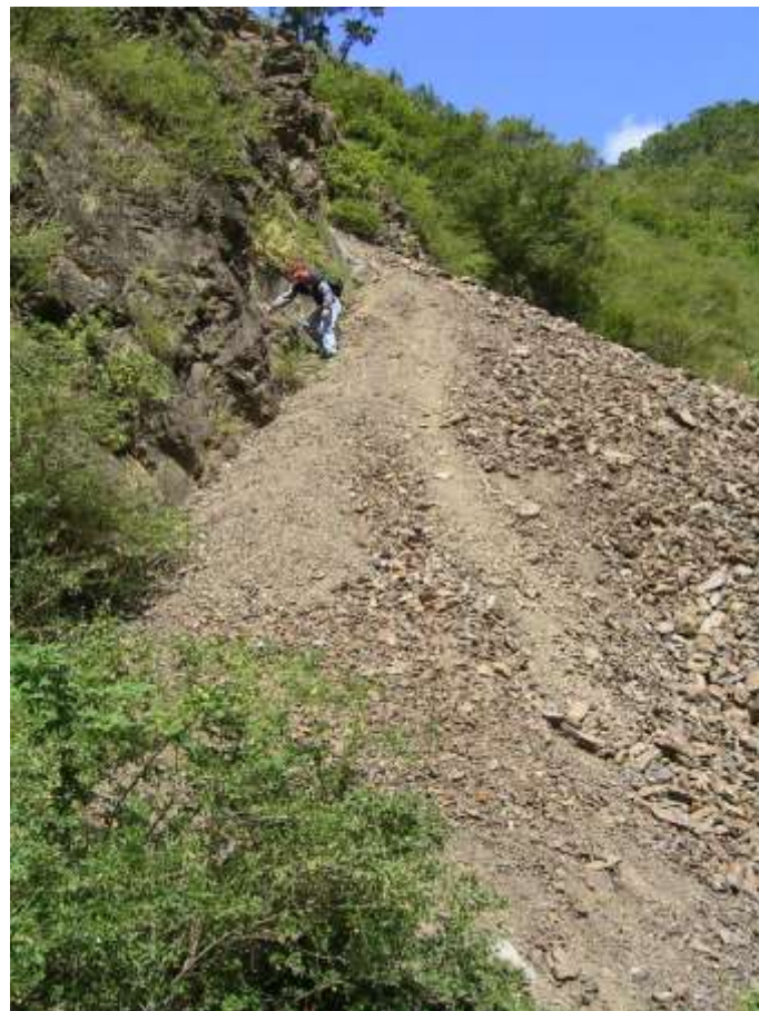
圖 2.1-7 枋山溪北岸南迴鐵路施工便道所見大量碎屑堆積造成便道遭埋沒現象
