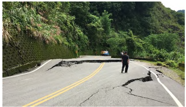
災後路基路面破壞
