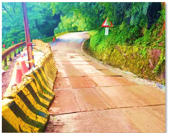
■ 5月31日/台14甲線合歡山公路翠峰18.6k路段因5月豪雨造成道路路基掏空
