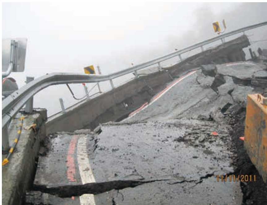
台7甲線41.7k迴頭彎下邊坡遭侵蝕造成路面塌陷
