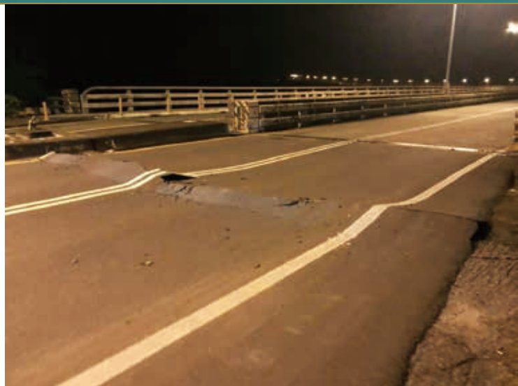
0206強震造成路面起伏
