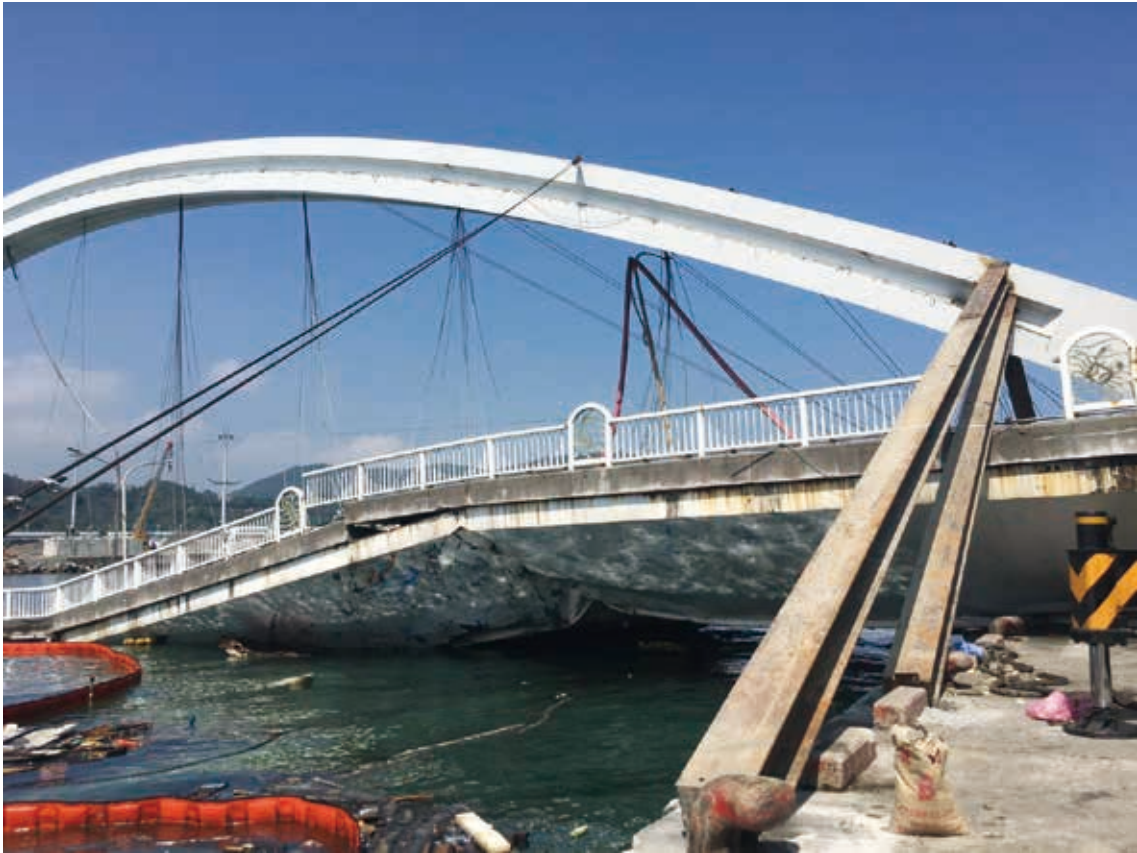
南方澳跨港大橋坍落漁港航道，阻斷漁船進出
