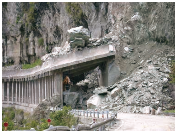
災害崩塌現場，大石壓壞明隧道
