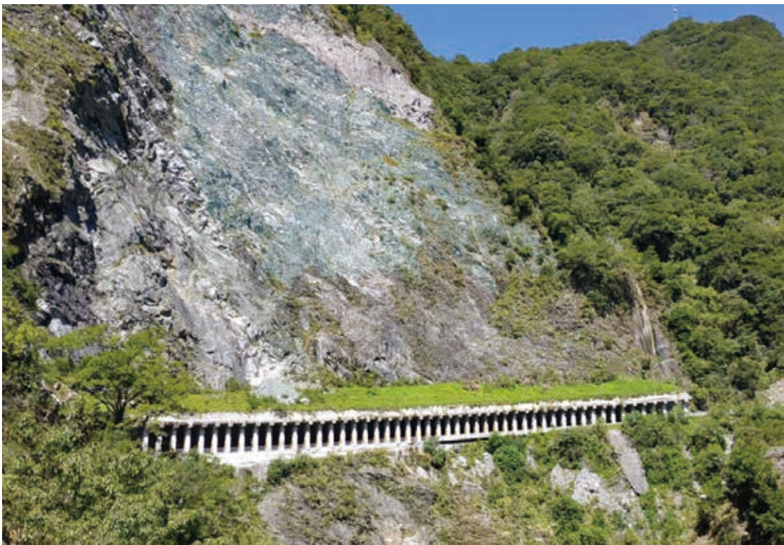
明隧道上方大片裸露邊坡
