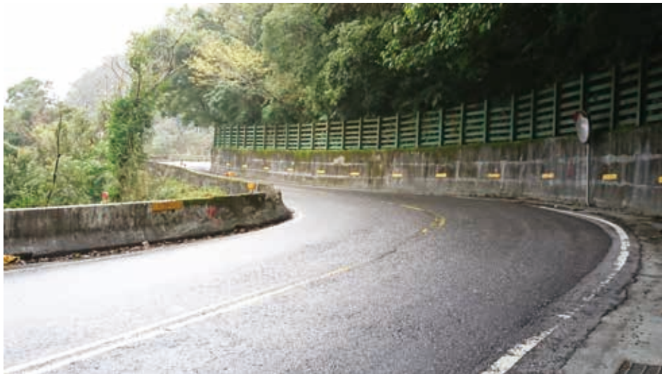
台9線南澳路段彎道改善前
