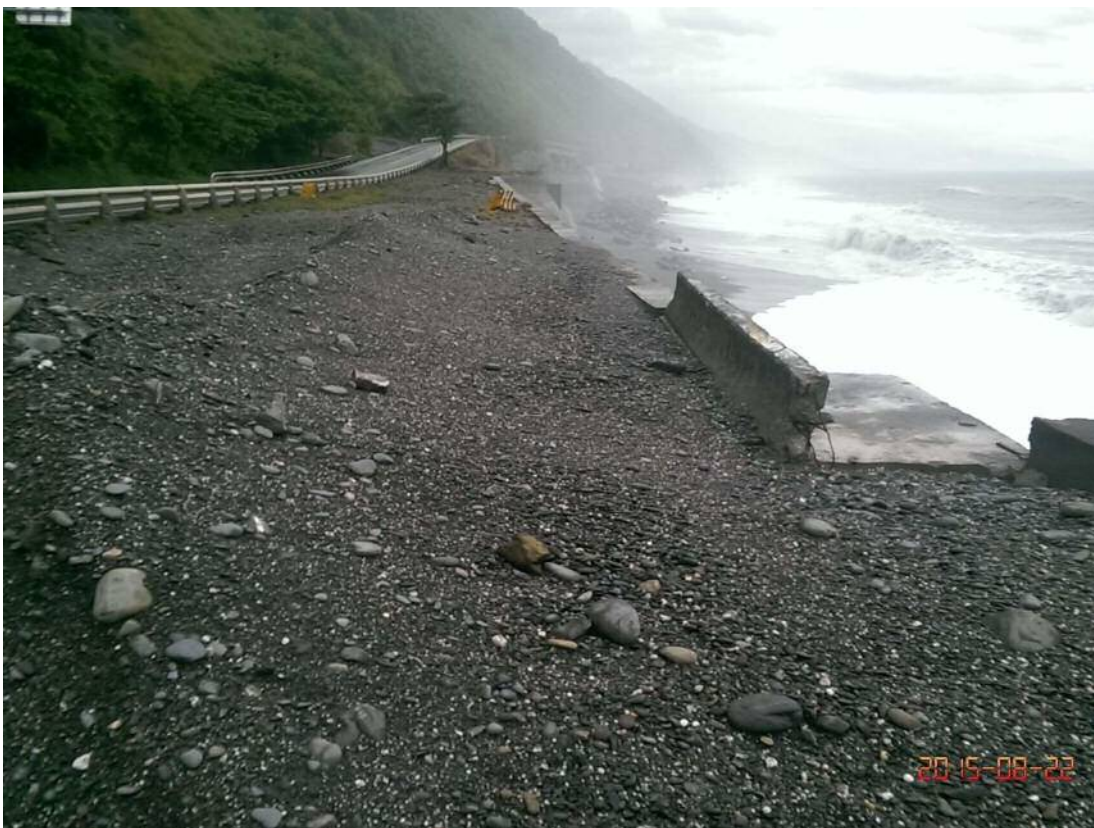
台 9 線多良-大竹路段東北季風海浪襲擊緊鄰台 9 線道路情形
