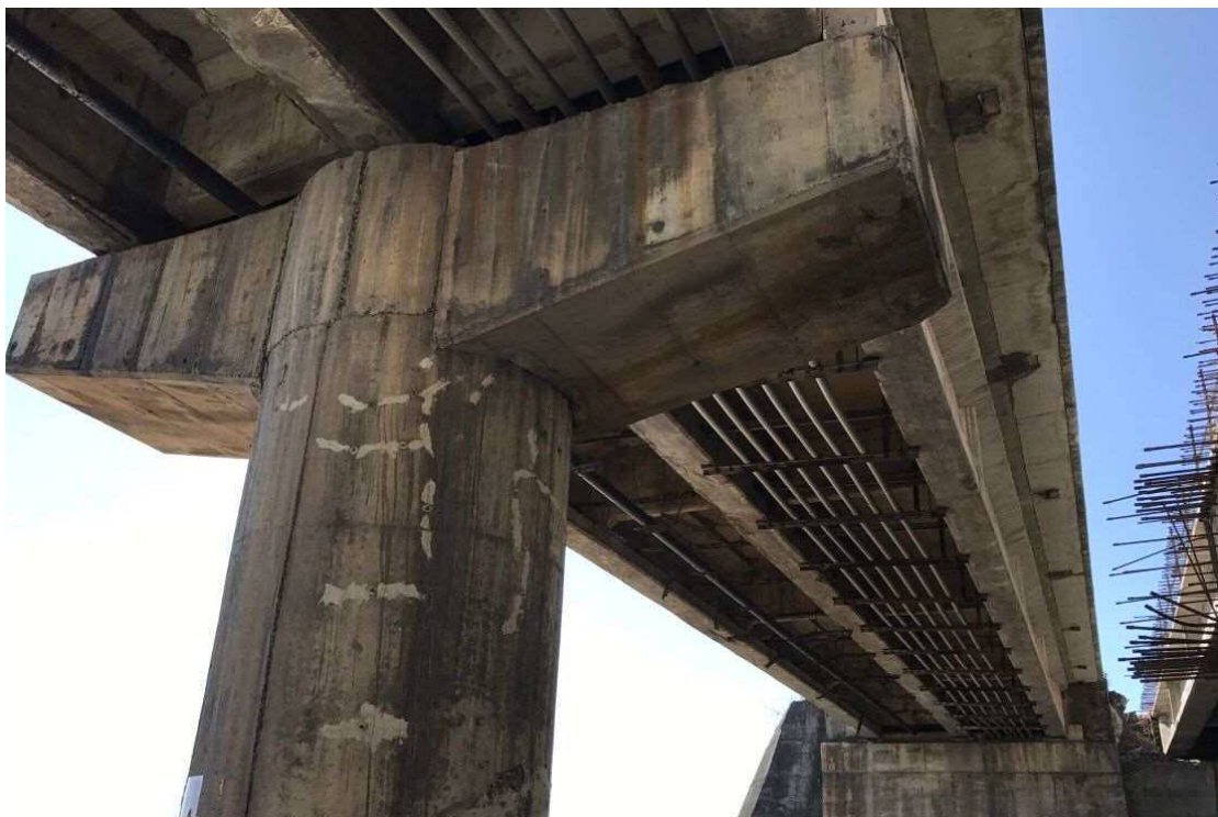
圖 2.3.3-1 多良海側橋橋墩已有混凝土開裂剝落鋼筋裸露情形
