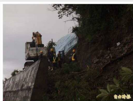
連日大雨，南迴台九線413.5公里路段傳出山壁坍方，公路局動員搶修。(記者陳賢義攝)
