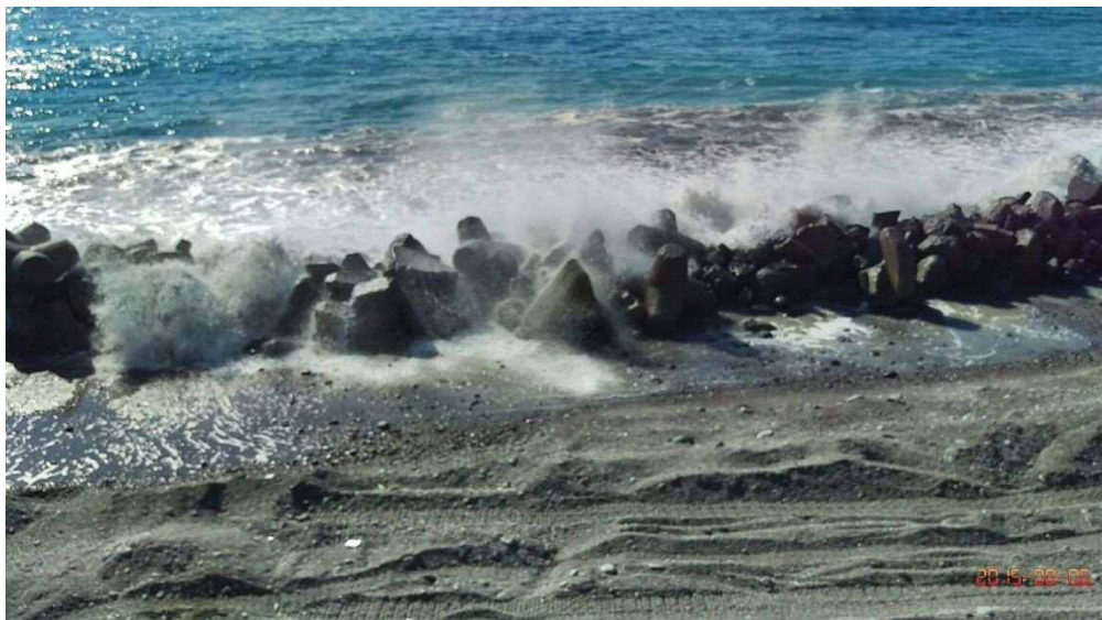
台9線多良-大竹路段現有消波塊受浪襲損壞情形
