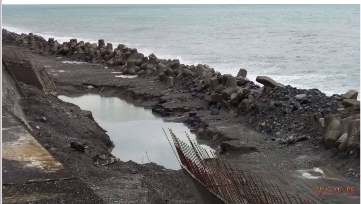
台 9 線多良-大竹路段海浪襲擊後造成灘地掏空危及緊鄰台 9 線道路情形
