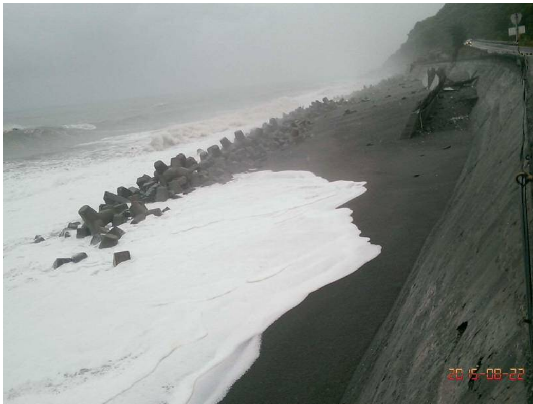
台 9 線多良-大竹路段東北季風海浪襲擊緊鄰台 9 線道路情形
