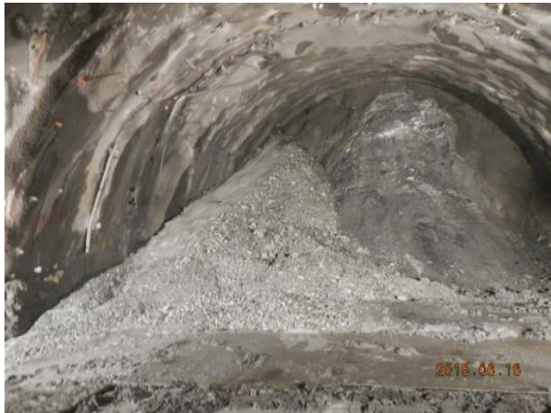
北上線4K+791.1抽坍現況
