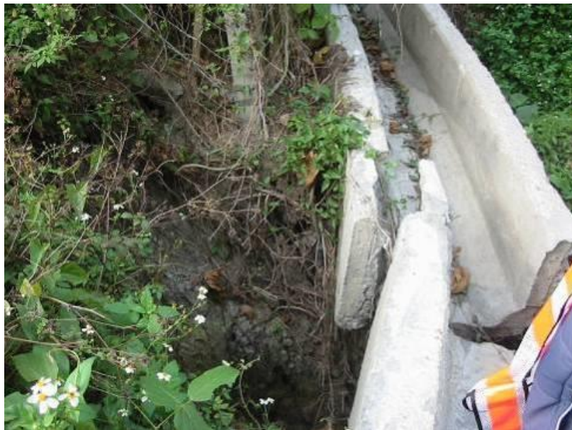
圖 12.20 南二高 310K+430 邊坡排水溝因沖蝕溝而破壞
