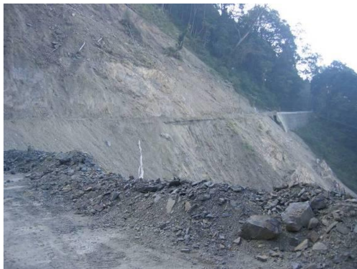
圖 12.23 大鹿林道邊坡地表沖蝕裸露
