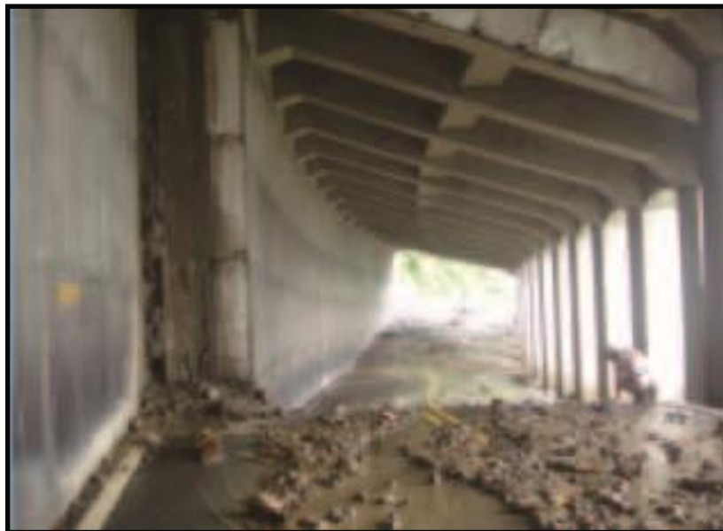
圖 4.16 靠山壁之側牆(或側柱)因土壓力過大而破壞
