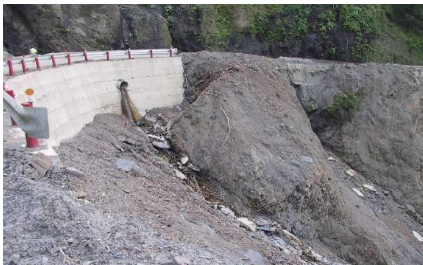
圖 12.22 台 21 線坡趾無尾溝沖刷造成下邊坡擋土構造物損毀
