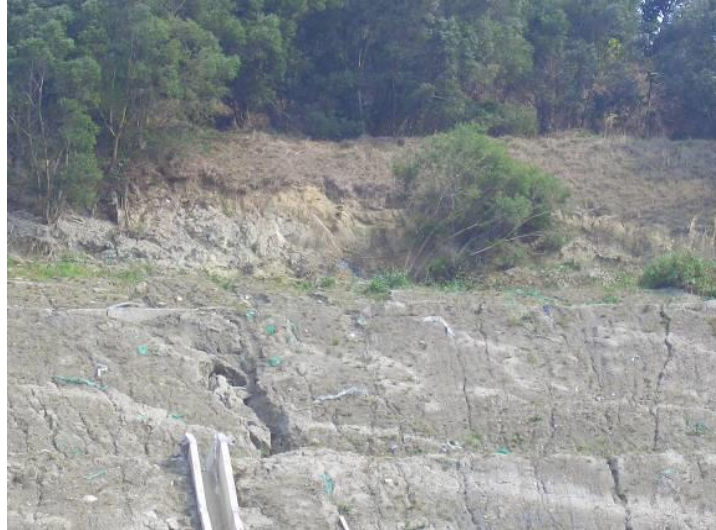
圖 12.44 南二高東山服務區外側泥岩邊坡發生深層滑動
