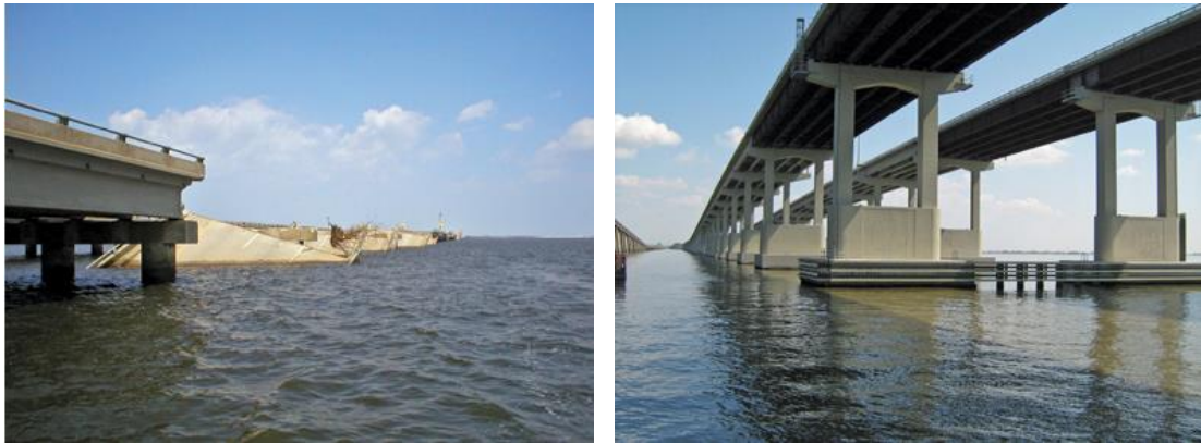
圖 2.18 美國 I-10 雙跨度橋梁於卡翠娜風災後修復情形
