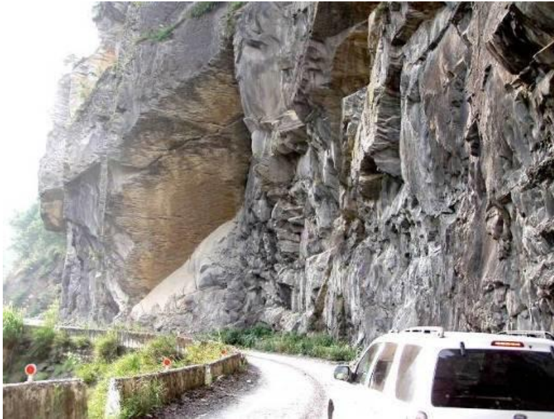
圖 12.58 力行產業道路岩石楔型破壞造成落石
