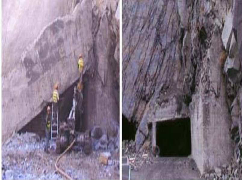
圖 4.15 上邊坡坍方或落石壓垮明隧道
