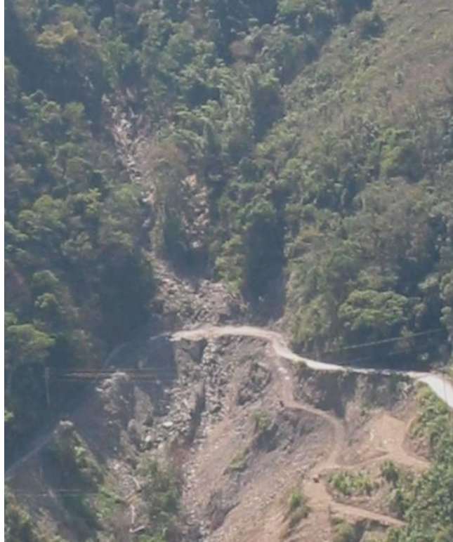
圖 12.27 力行產業道路下邊坡向源侵蝕破壞情況
