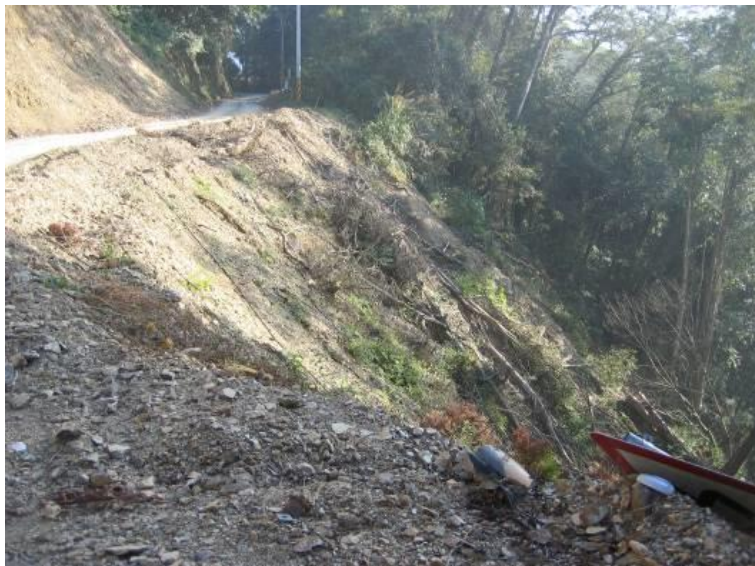
圖 12.39 大鹿林道下邊坡發生淺層破壞
