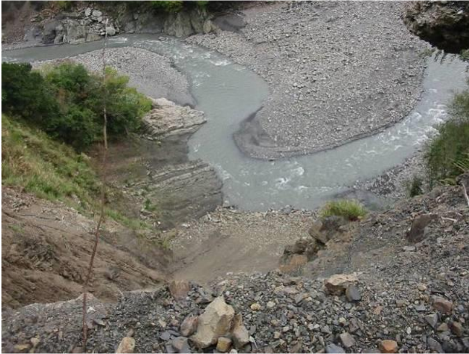
圖 12.35 尖石鄉竹 60-1 凹岸沖刷造成路基流失
