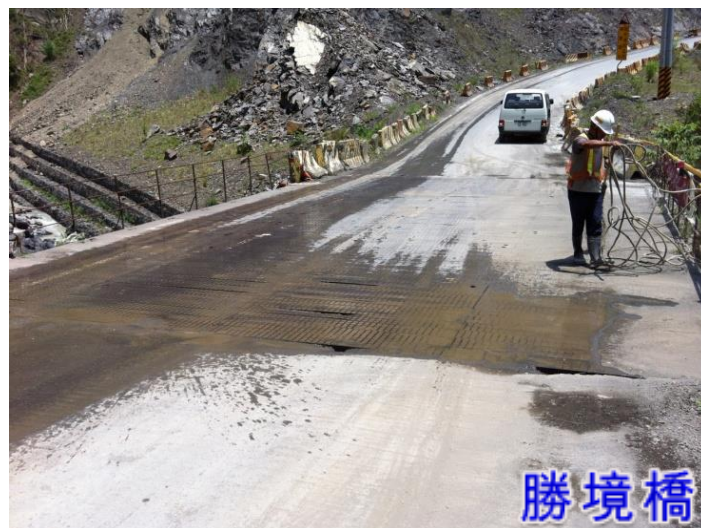
圖 11.19 鋼便橋伸縮縫狀況不良
