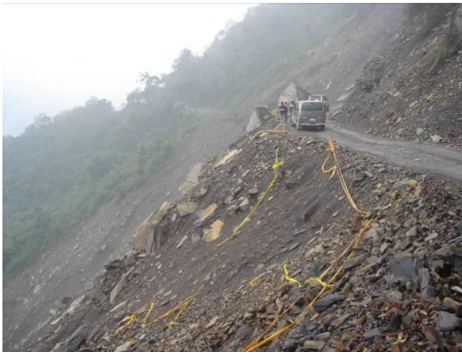
圖 12.34 大鹿林道 2K+700 邊坡凹岸沖刷影響深度達數百公尺
