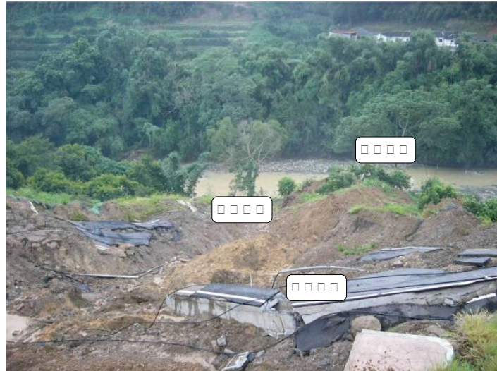
圖 12.32 竹 37 線凸岸之土砂堆積與凹岸沖刷造成道路坍方
