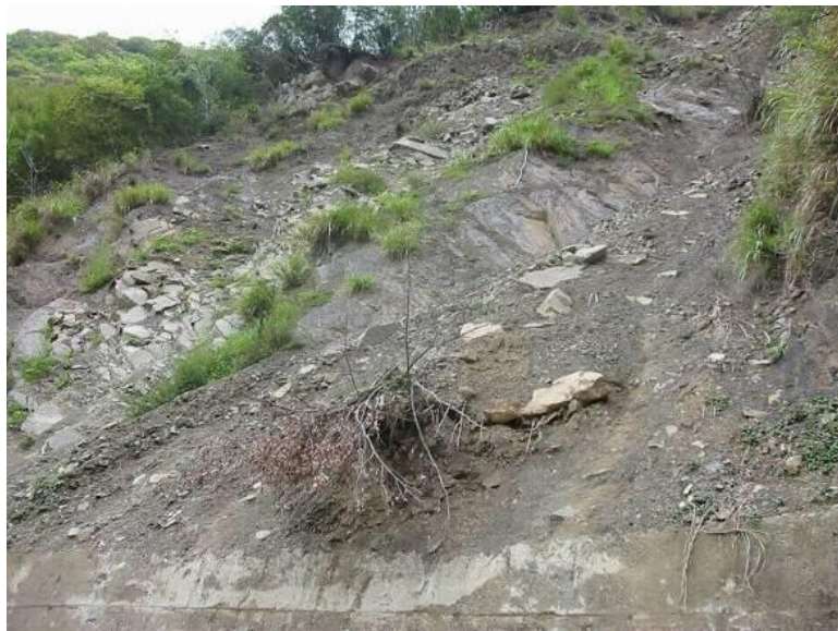
圖 12.25 尖石鄉竹 60-1 上邊坡因缺乏排水溝形成沖蝕溝
