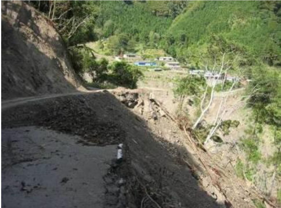
圖 12.19 新竹縣大鹿林道邊坡因豪雨造成路基流失
