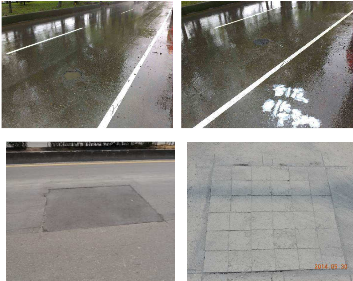
圖 1.一般鋪面坑洞及修補狀態
