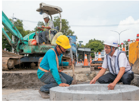
嘉 106 線的第二期工程仍在施工中，位於大學路二段五岔路口。（右為嘉義縣建設處長郭良江）
