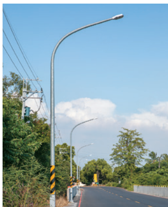
每 30 ~ 50 公尺增設一盞路燈，提升夜晚照明度。
