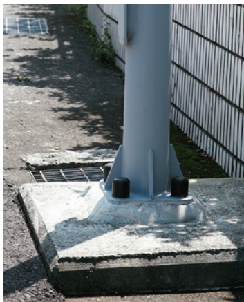
路燈底座和水溝蓋共構，避免佔用道路面積。
