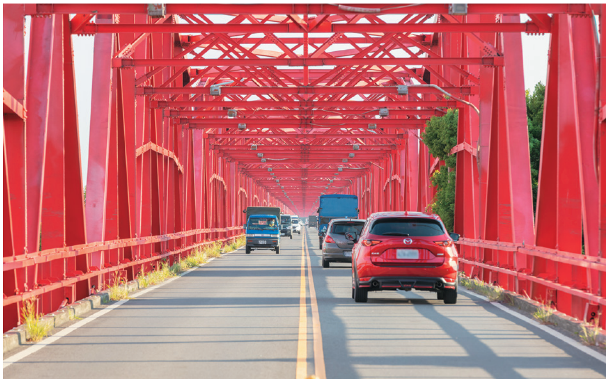
西螺大橋整修前伸縮縫龜裂（如右上圖），行駛其上會明顯感到車子一直跳動。
