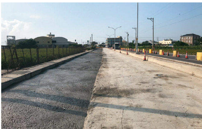
彰 206 線原路基狀況太差，幾乎整條條挖掉重做，並用低強度混凝土（Controlled Low Strength Materials，簡稱 CLSM）回填。
