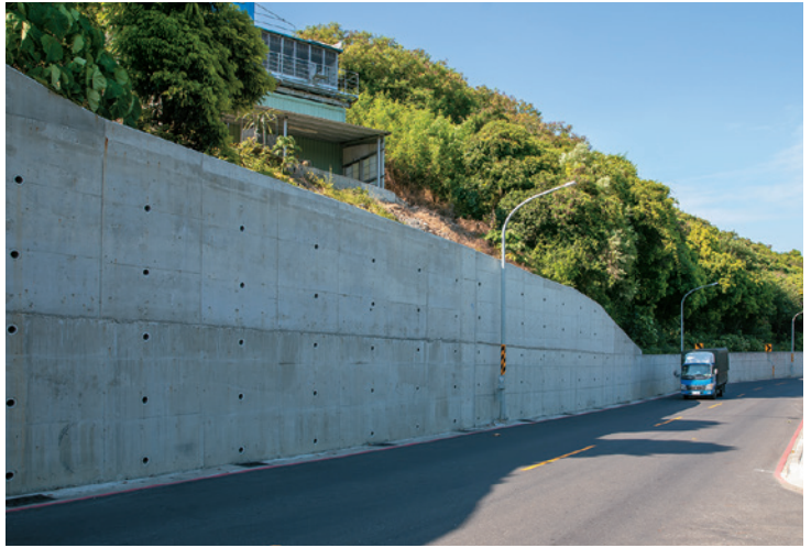
路旁的自然邊坡一遇雨日就易有逕流沖刷泥石，拓寬時同步改善排水設施，有效增加防洪能力。
