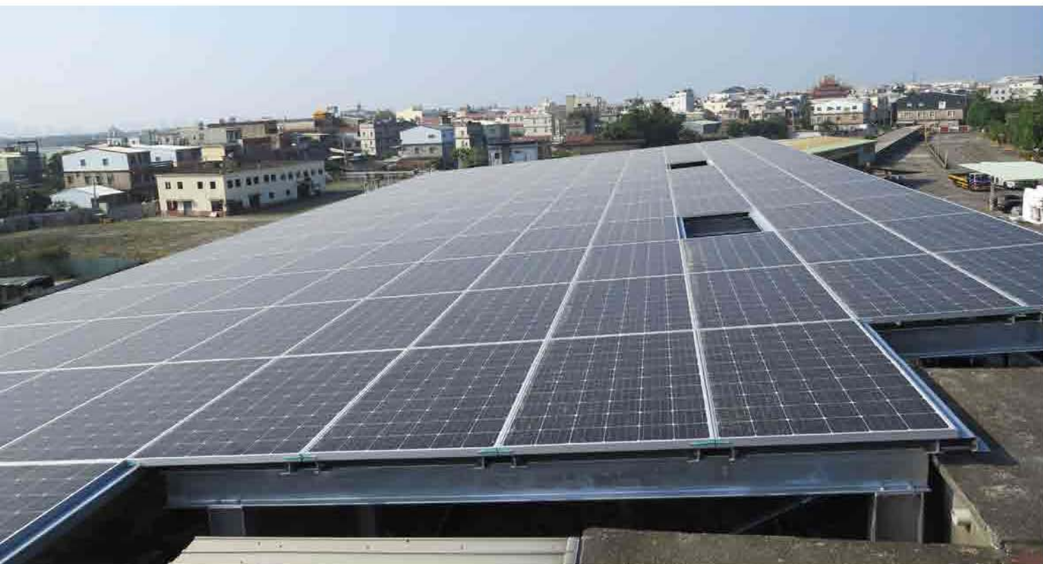
公路人員訓練所南部訓練中心屋頂「種電」情形
